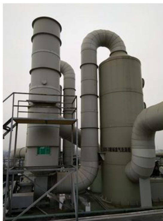
FQ-002 排气筒现场照片
