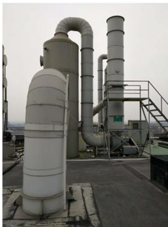
FQ-001 排气筒现场照片
