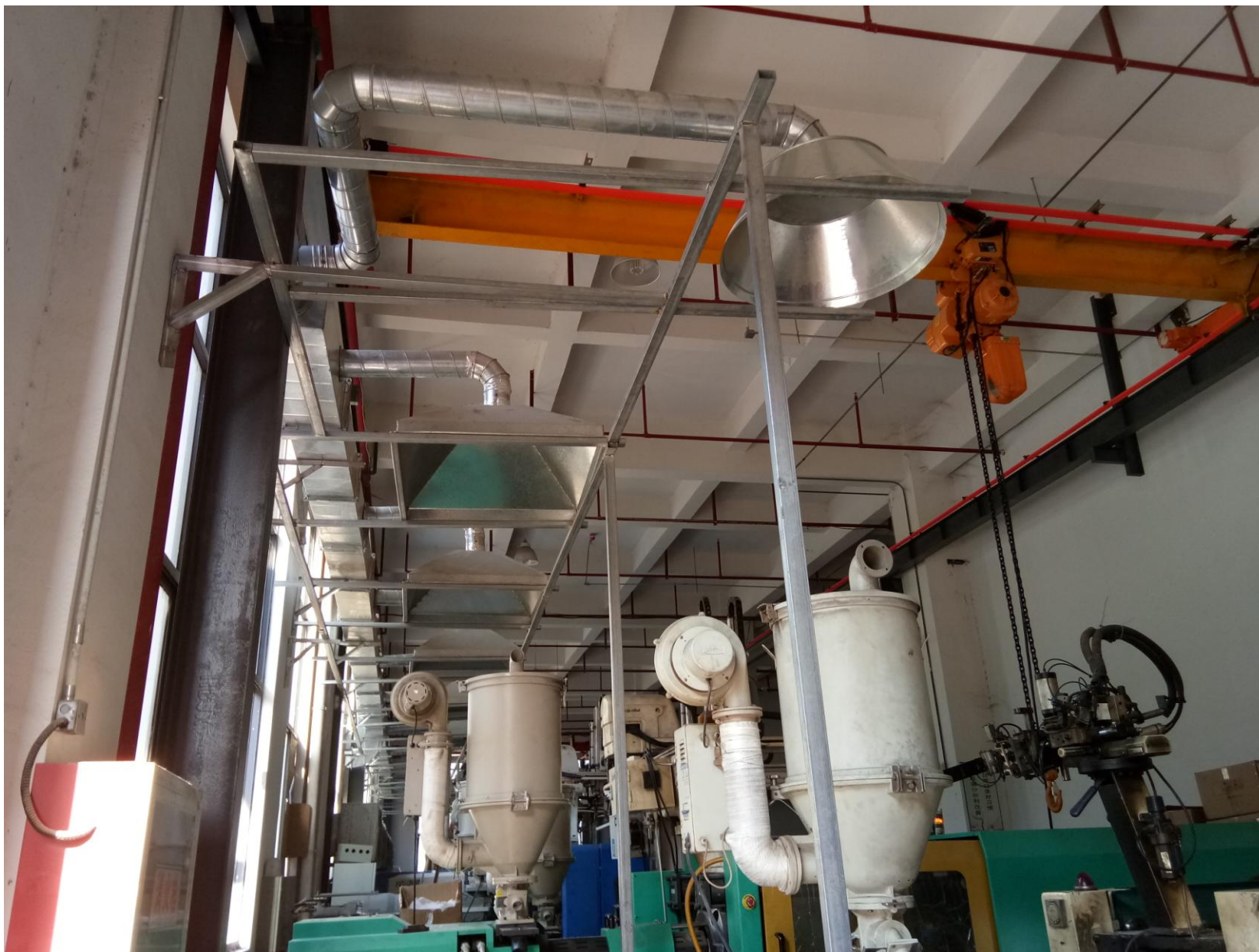
附图 6-3 废气处理设施实景图
