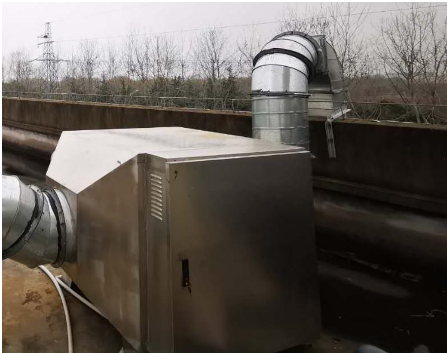
附图 6-1 废气处理设施实景图
