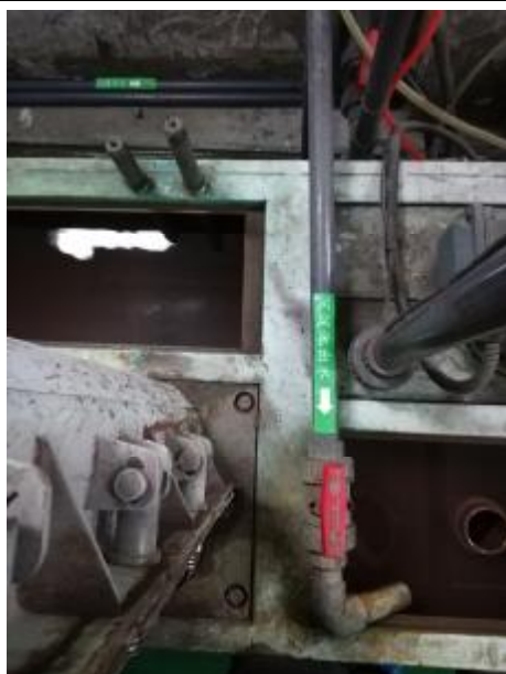
研磨废水过滤设备进、出水管线标识
