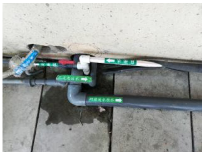
研磨废水沉淀池进、出水管线标识
