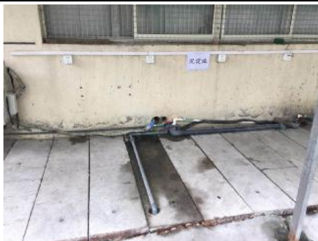
研磨废水沉淀池
