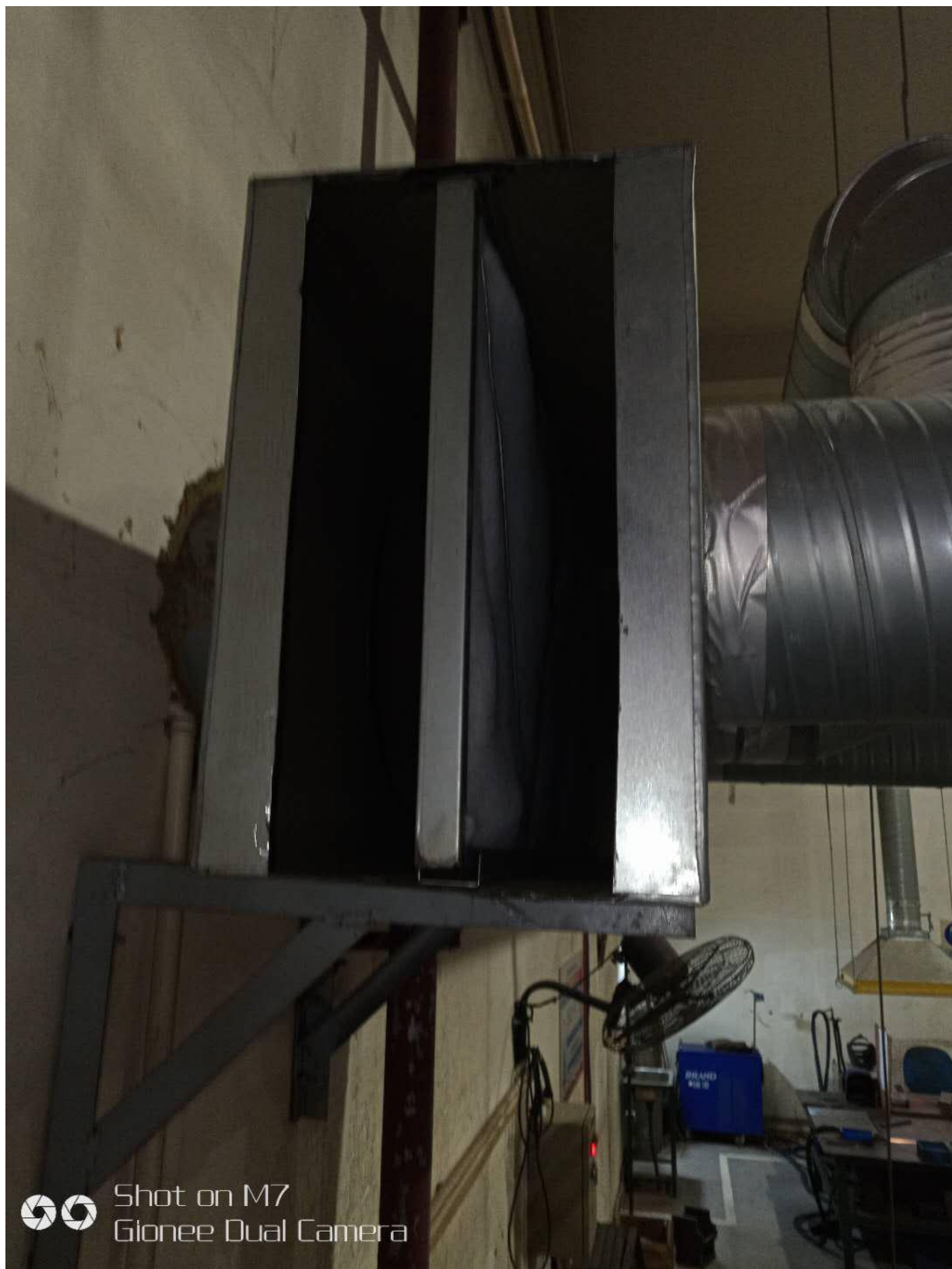
附图 5 焊接工序集气装置中过滤棉
