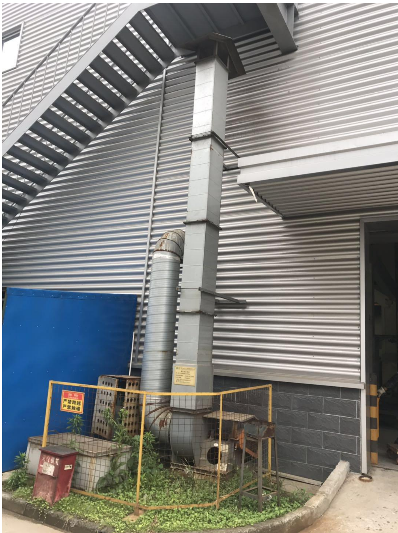
附图 6 焊接工序排气设施
