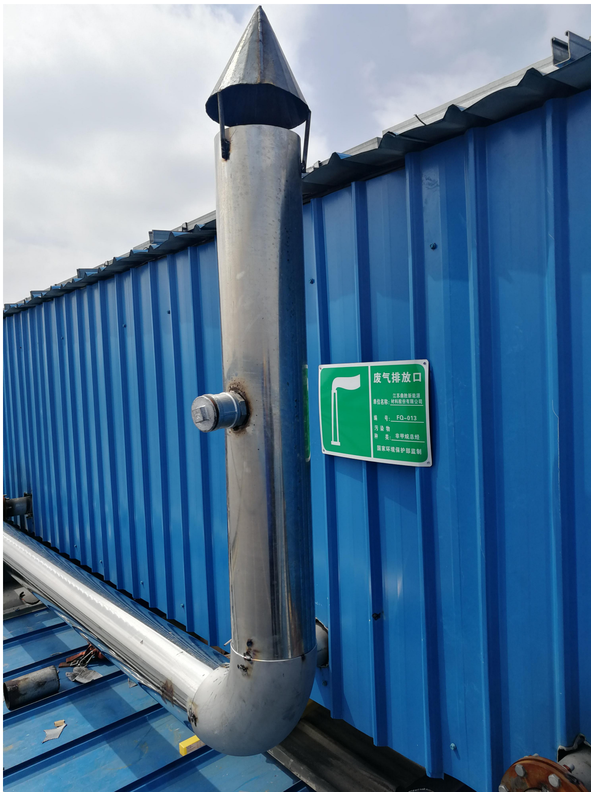
附图 11 退火炉废气排气筒 (FQ-013)
