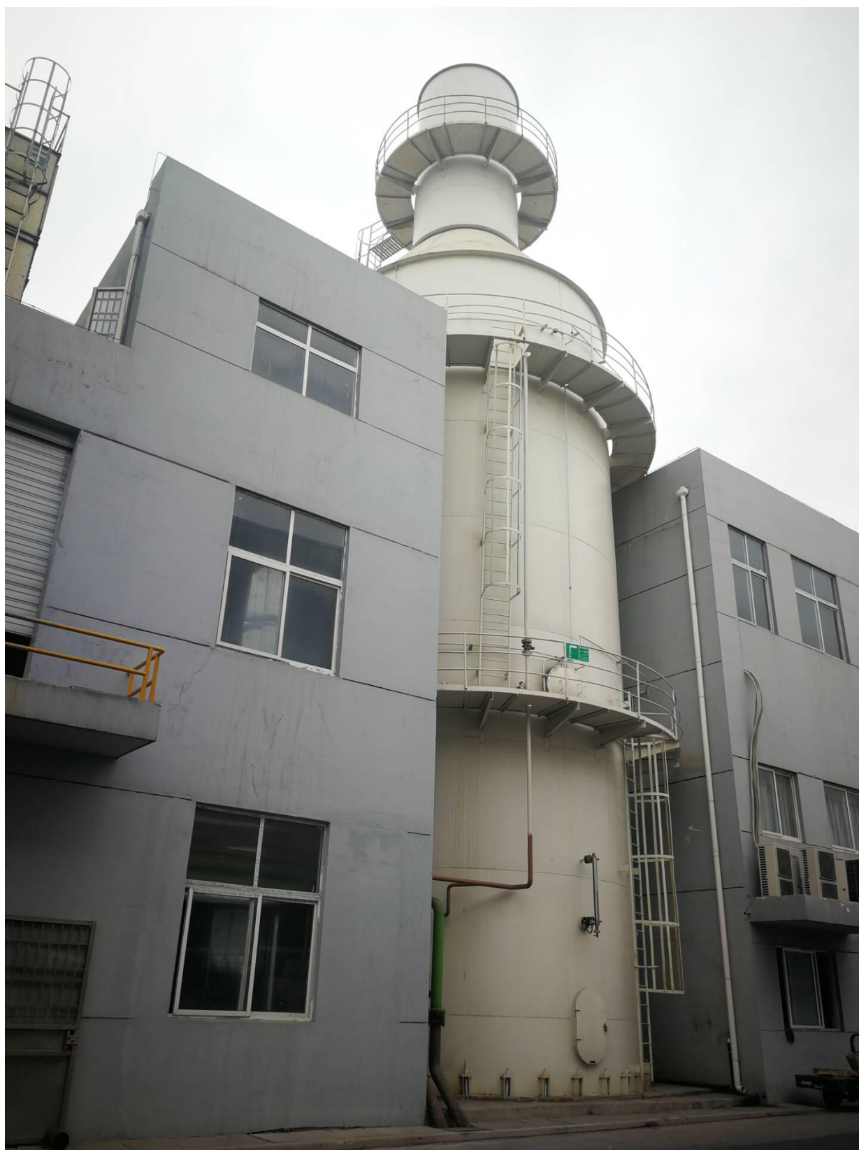
附图 7 冷轧机油雾排气筒 (FQ-010)
