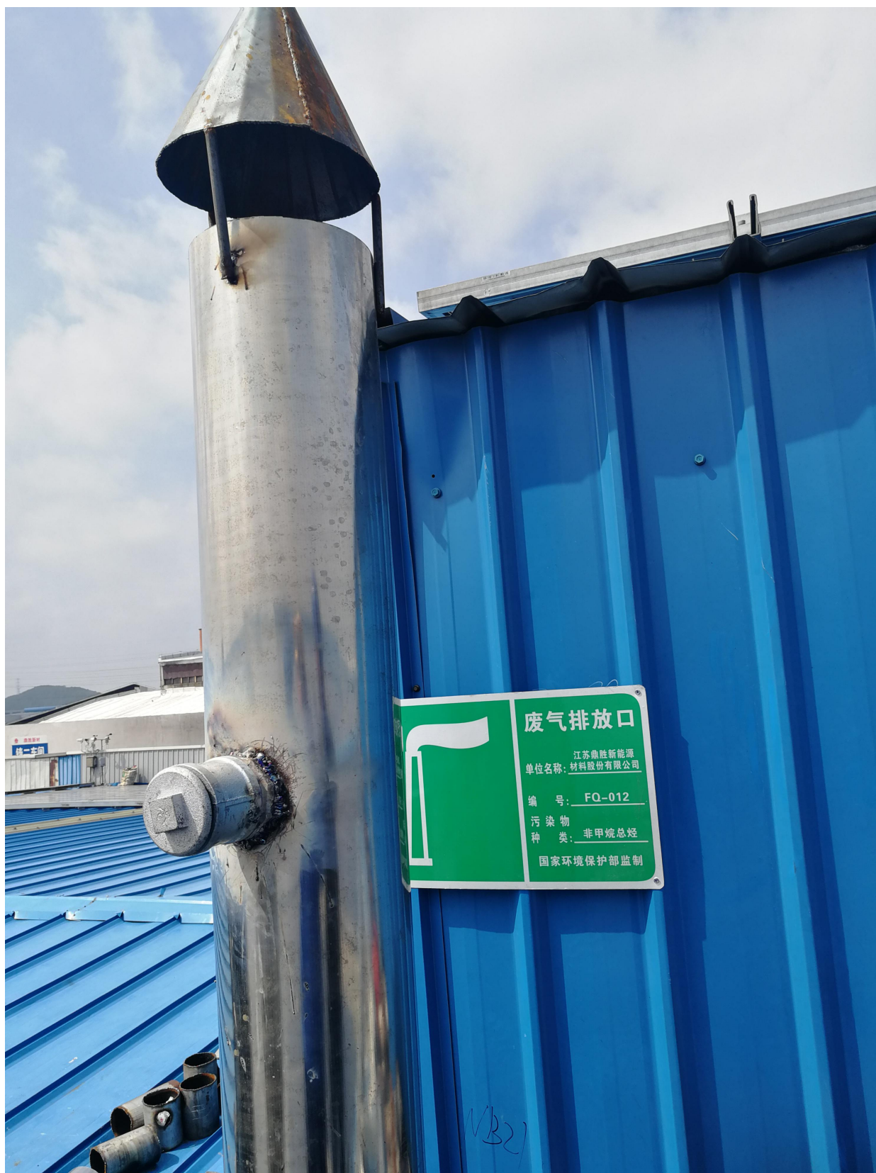
附图 12 退火炉废气排气筒 (FQ-012)
