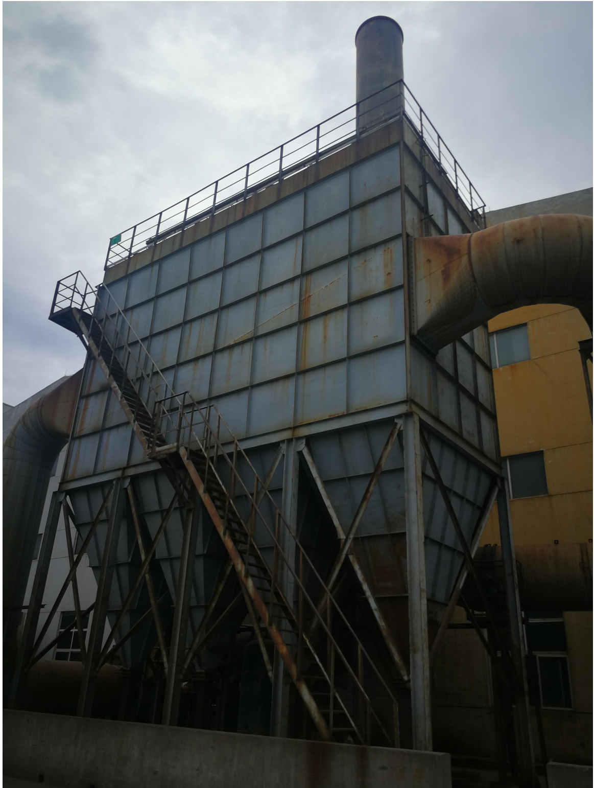
附图 9 熔铝炉、保温炉废气排气筒（FQ-035）
