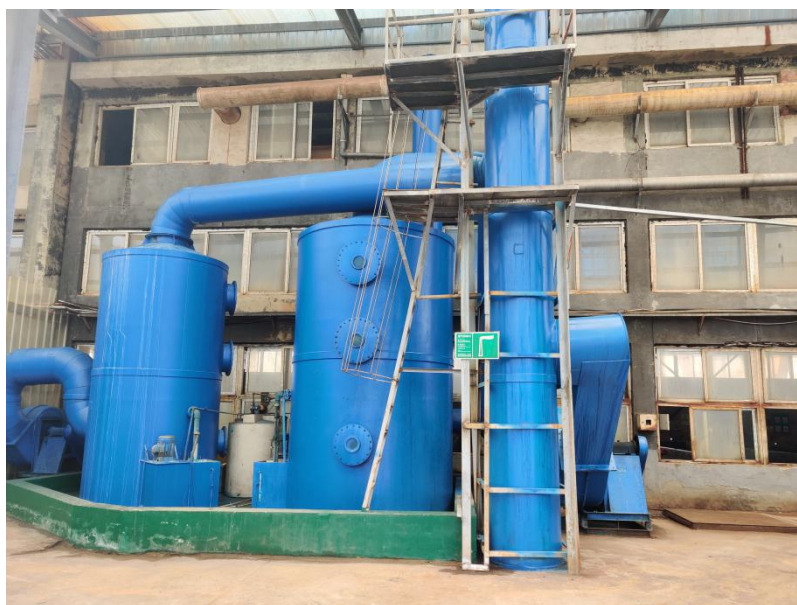
图4.3-9 酸性废气处理设施
