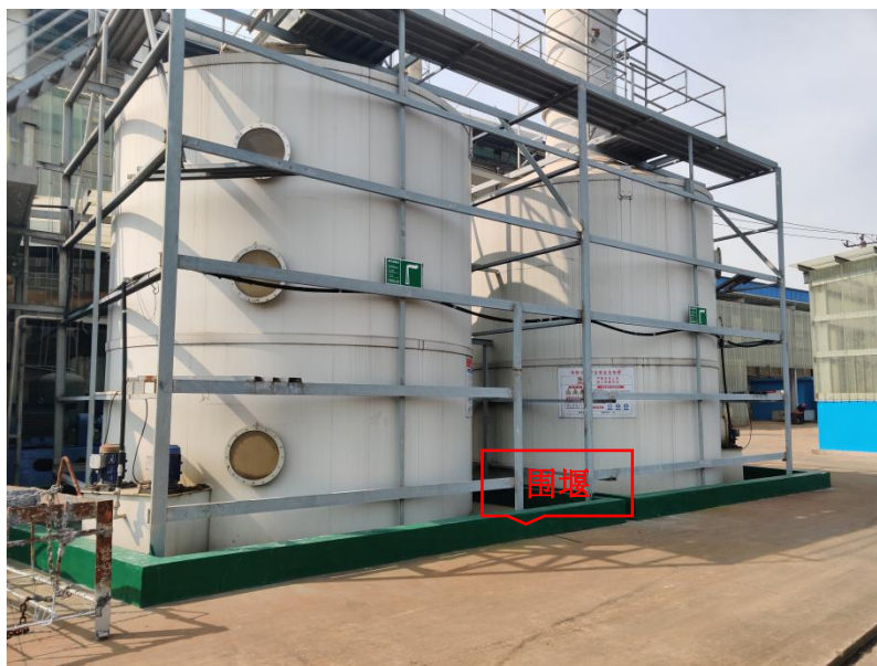
图4.3-8 粉尘废气处理设施
