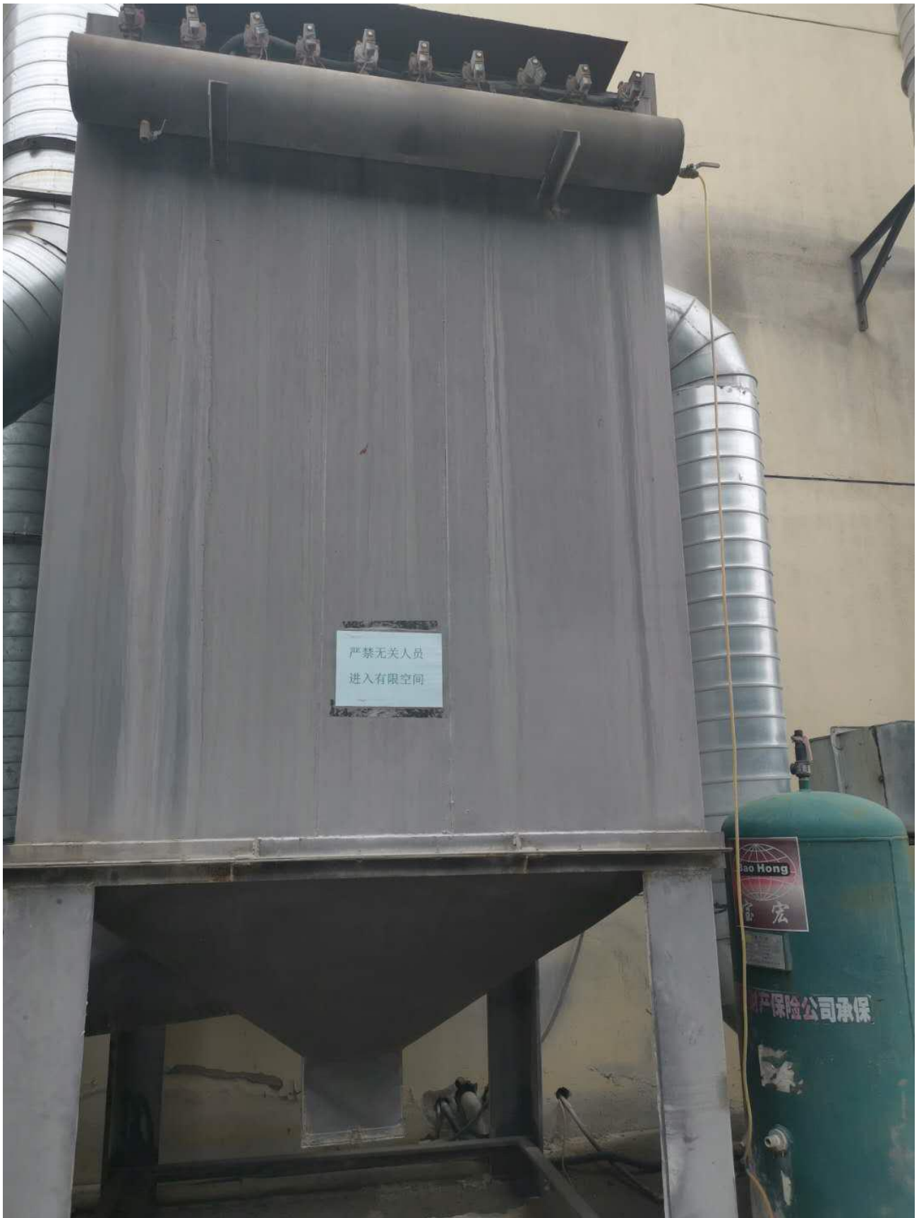
附图 5 废气处理设施实景图（布袋除尘器）
