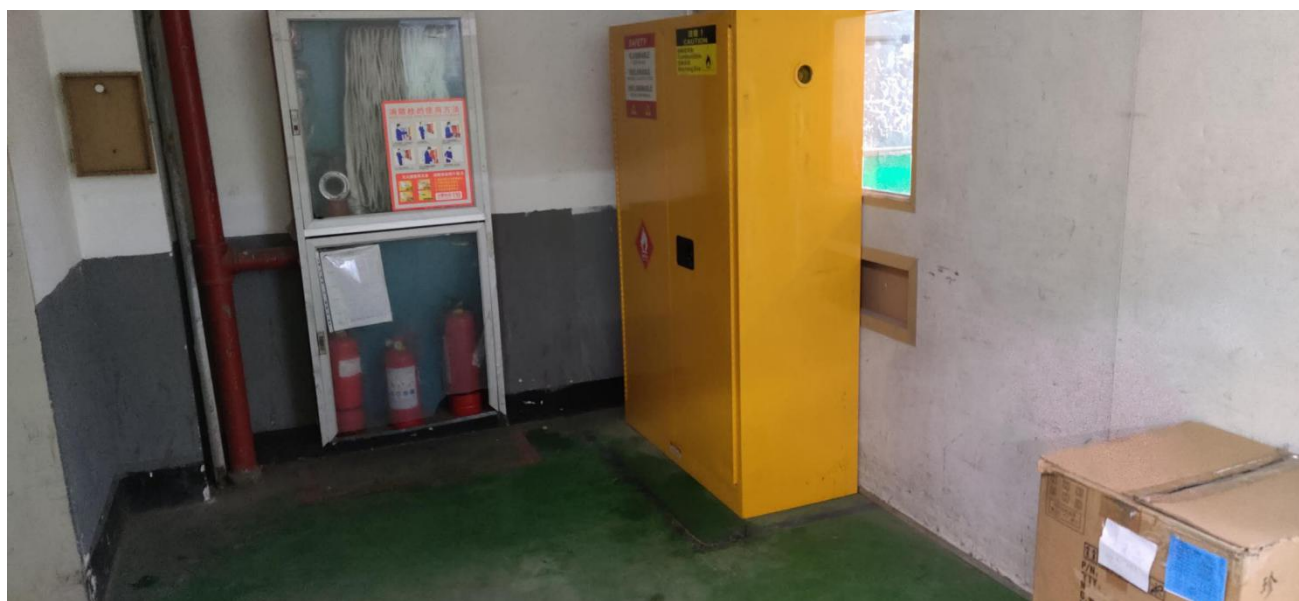
图4.3-10 化学品暂存区
