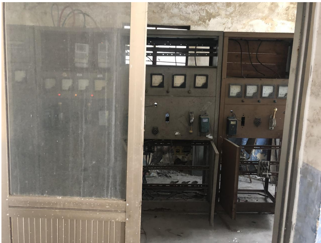
图2.3-16 地块内配电房内部现状图
