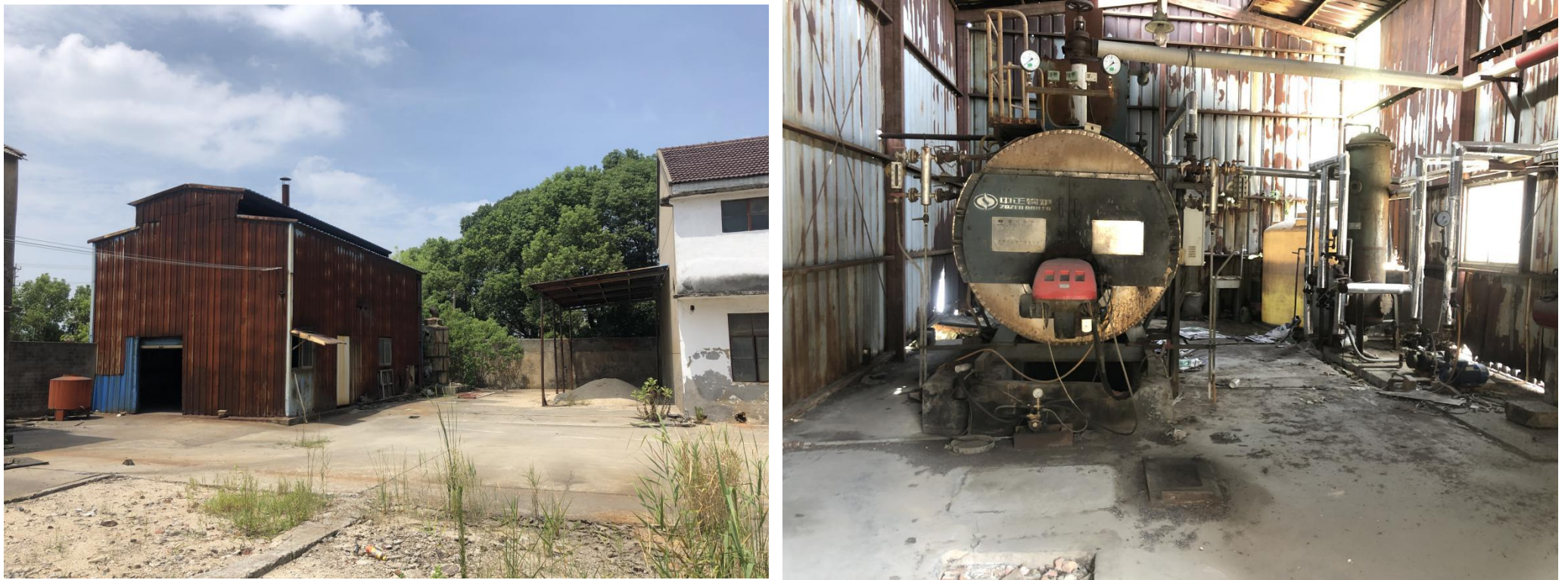
图2.3-20 地块内锅炉房内外现状图
