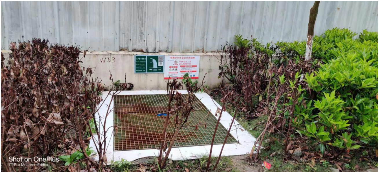
图5.1-17 生产废水排口
