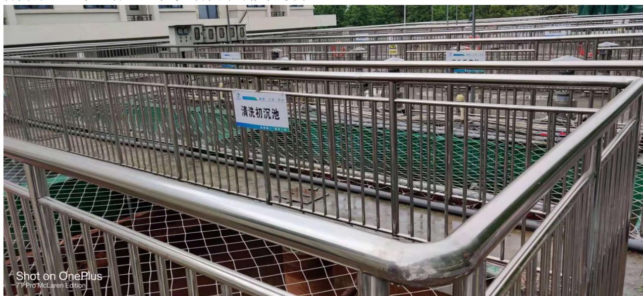
图5.1-2 废水处理站池
