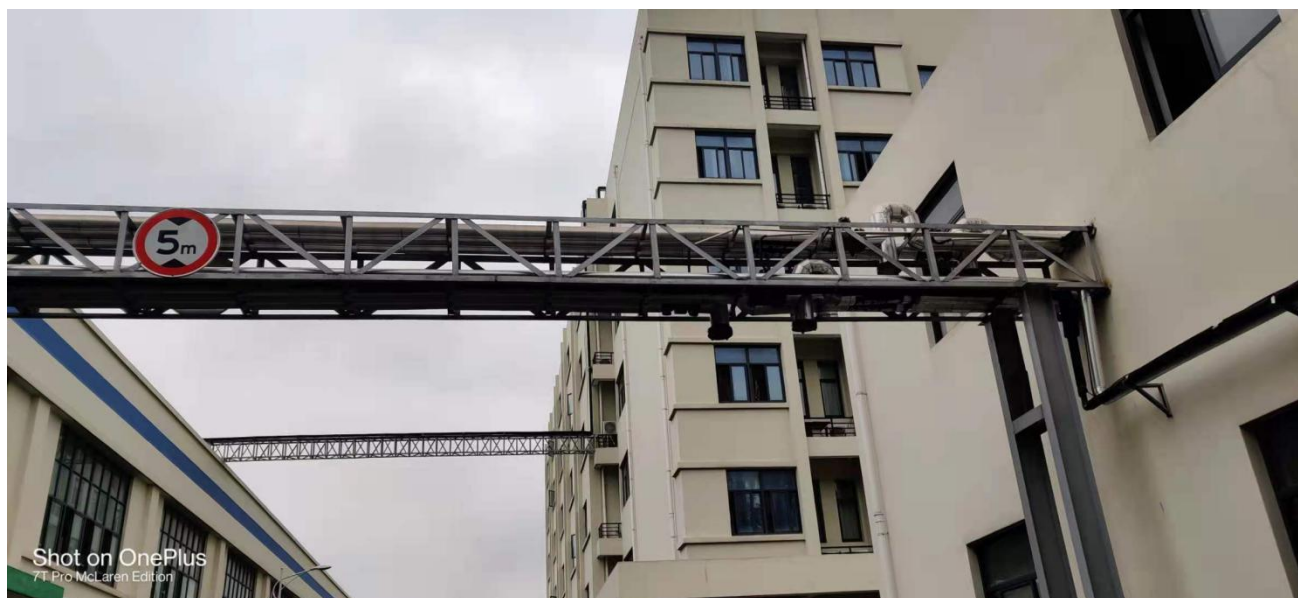
图5.1-4 生产废水管道
