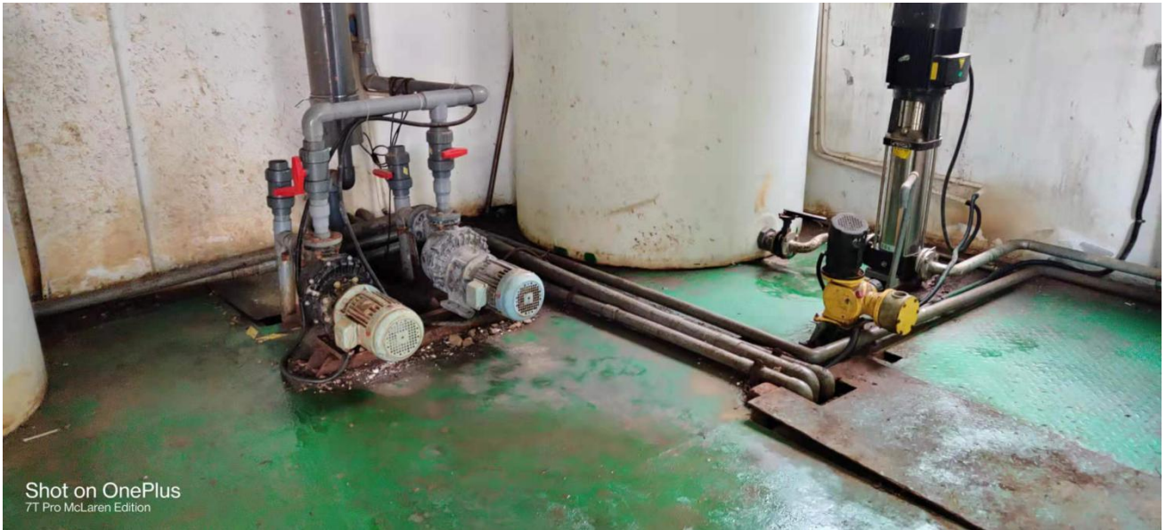
图5.1-15 危废仓库收集池
