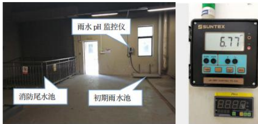
图5.1-8 日月光消防尾水池、初期雨水池
