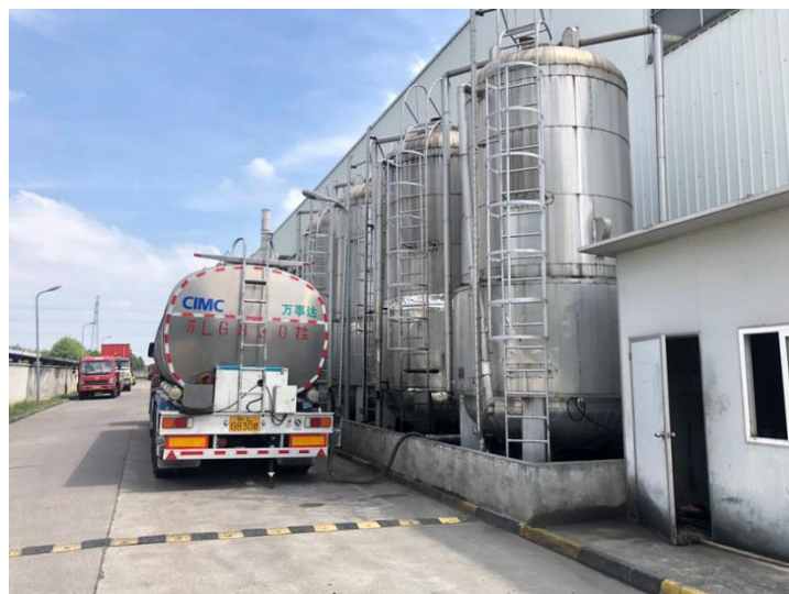
图2.3-11 氯化石蜡储罐
