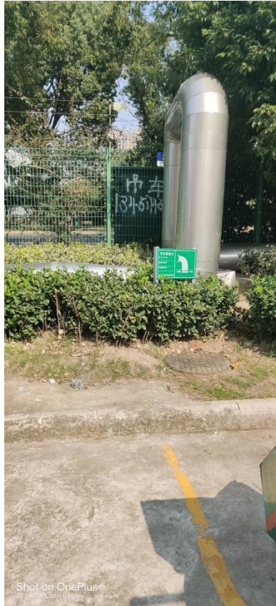
图5.1-7 生活污水排口
