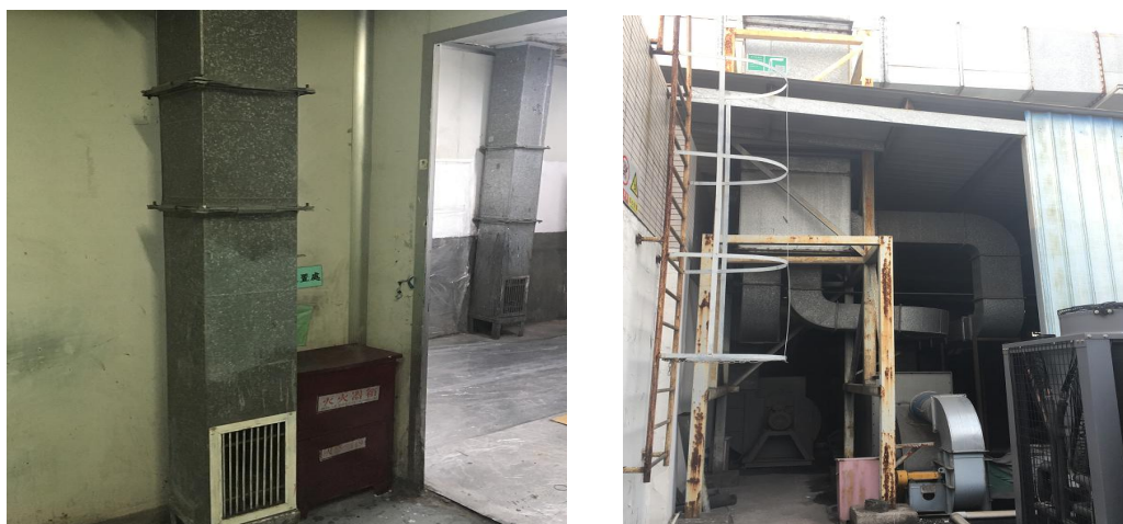
图 2.2-7 喷房废气收集、处理装置
