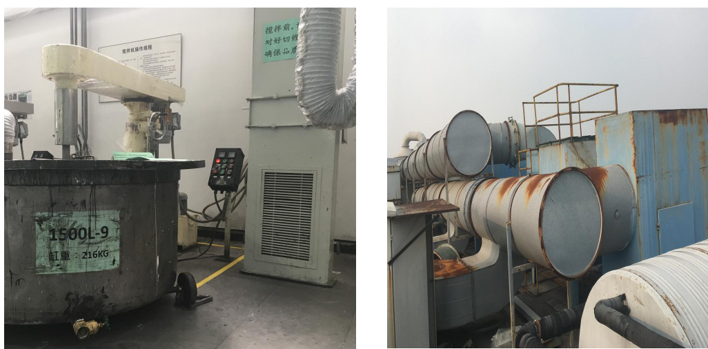
图 2.2-6 车间废气收集、处理装置
