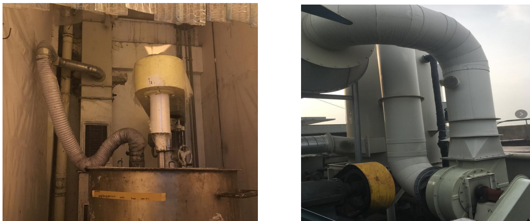
图 2.2-5 预分散工序废气收集、处理装置
