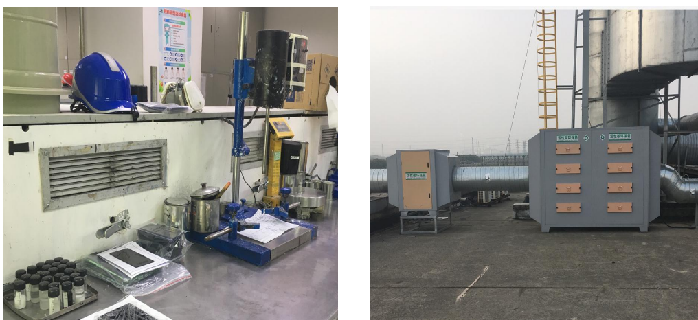
图 2.2-8 研发中心废气收集、处理装置
