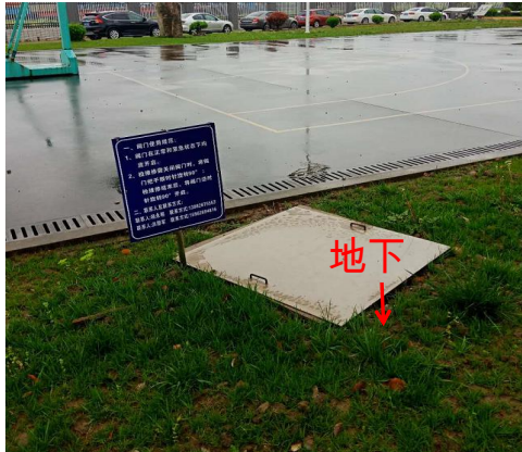
图 3.2-4 事故应急池现场图
