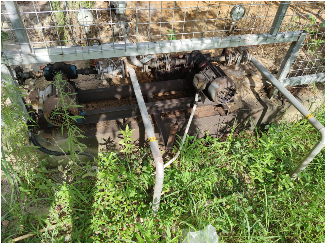
图5.1-12 柴油储罐区传输泵
