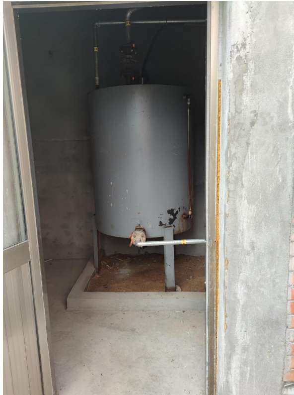
图5.1-5 发电机房柴油储罐
