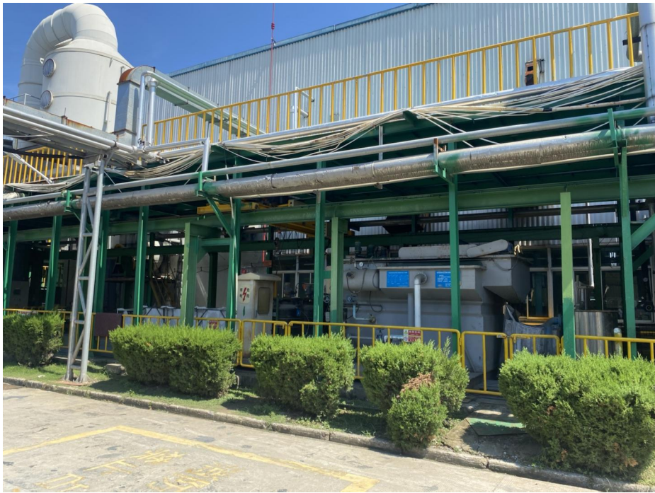
图5.1-6 废水运输管道
