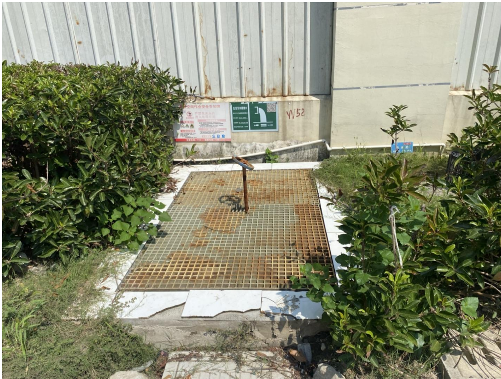
图5.1-20 生活污水排口
