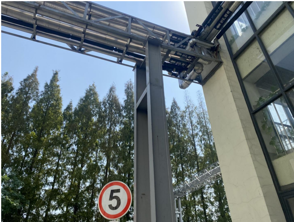
图5.1-4 生产废水管道
