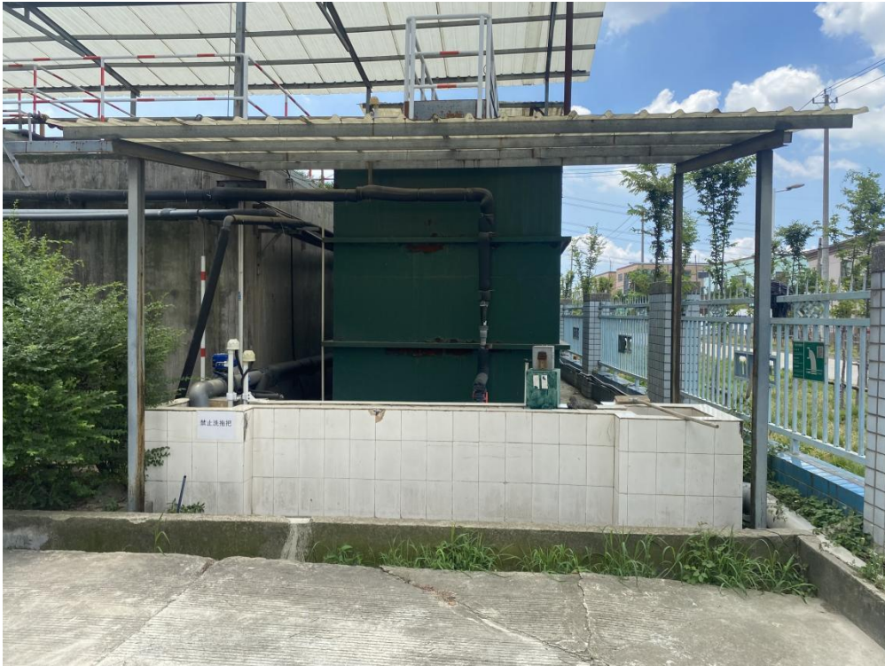
图5.1-13 生产废水排口
