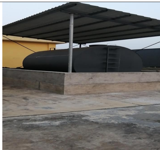
整改前片钒炉燃料使用柴油
