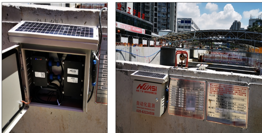
图 5.3-3 采用锂电池与一体化电箱方式安装完成图
