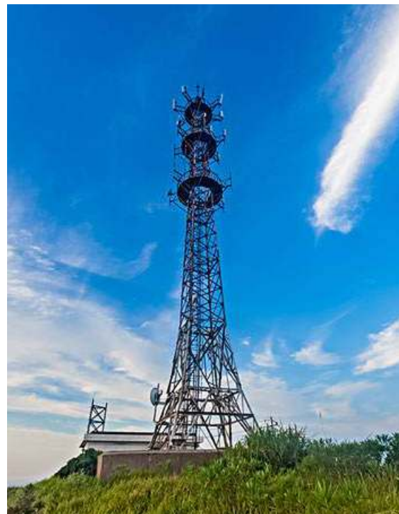
铁塔倾斜监测
