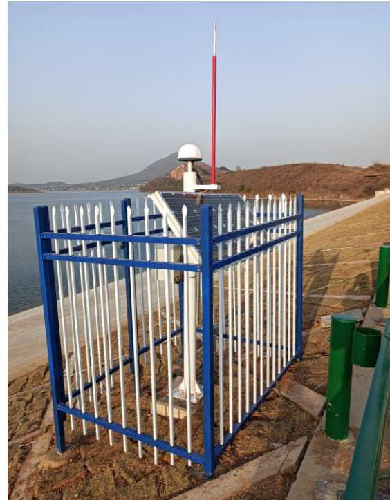
大坝位移监测
