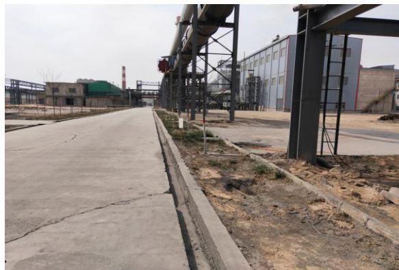
矩形砼排水沟
