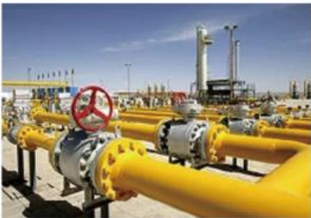
石油天然气管道
