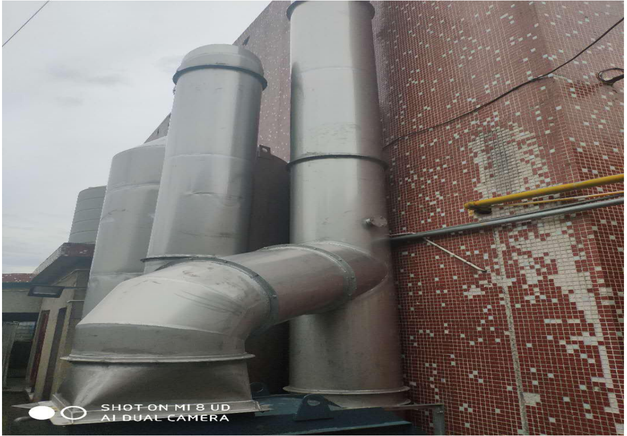
压铸脱模、熔化炉、天然气燃烧废气治理设施（碱喷淋）
