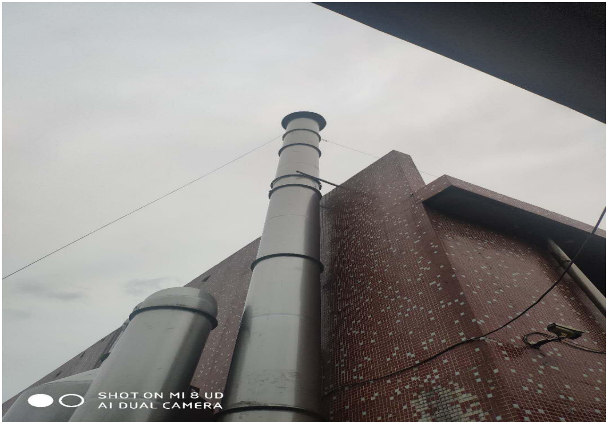
压铸脱模、熔化炉、天然气燃烧废气排气筒出口
