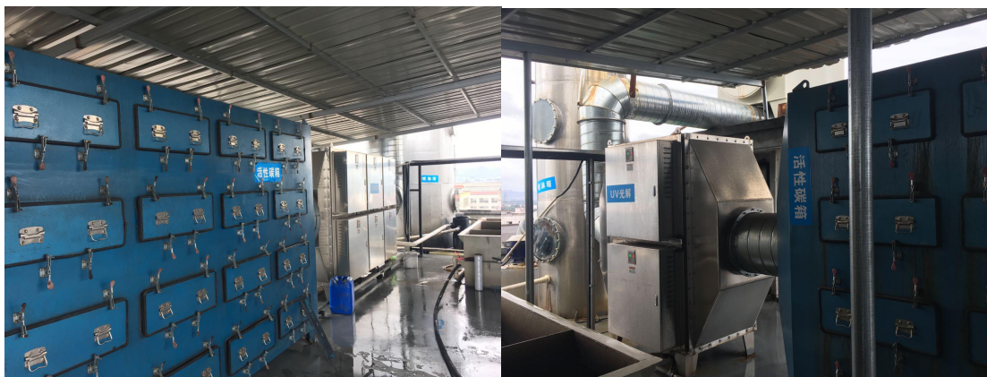
(喷涂废气) 水喷淋塔+UV 光解+活性炭吸附处理设备 (烘干废气)
