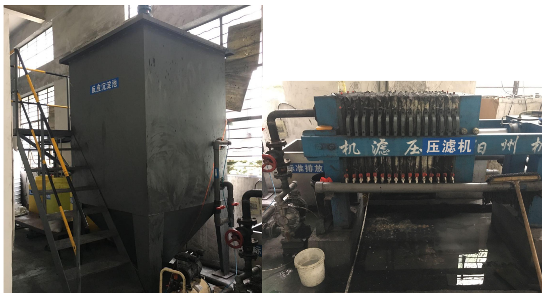
生产废水处理设备
