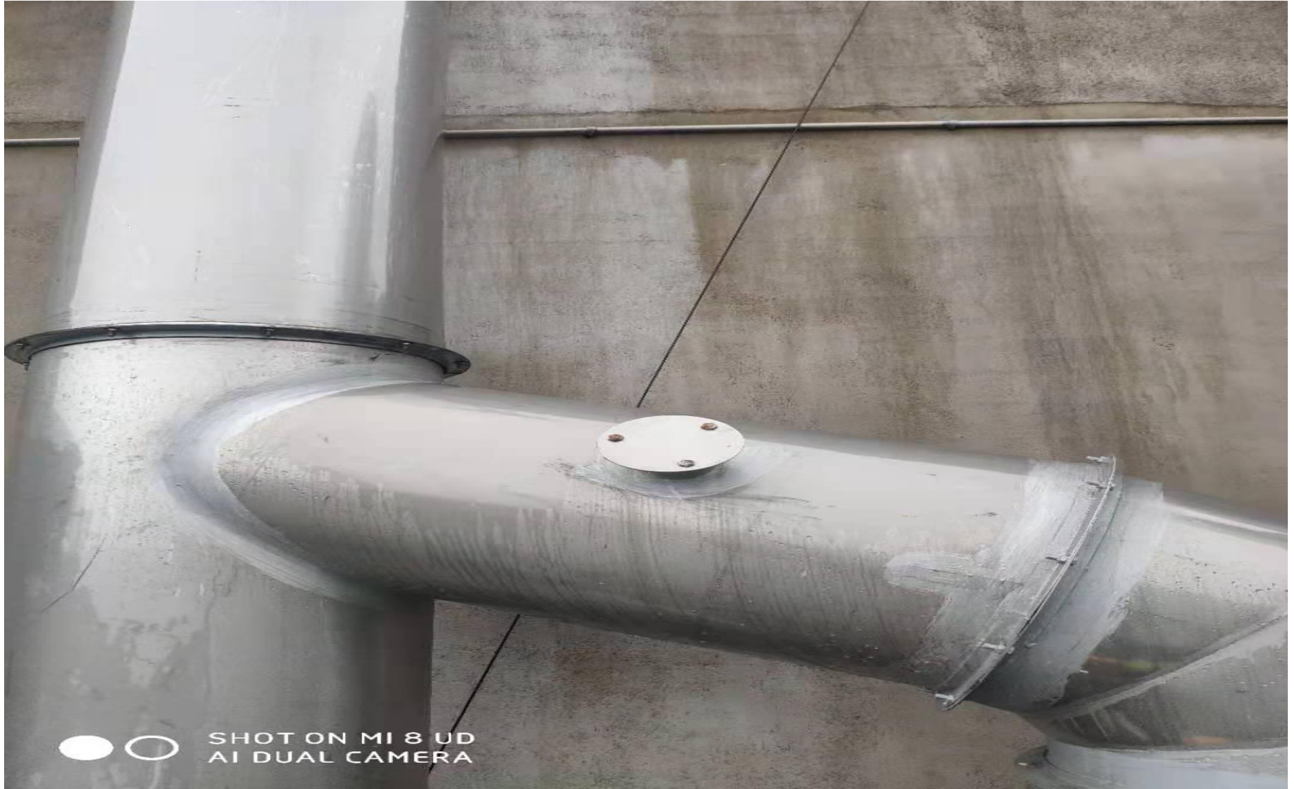
脱模废气采样口
