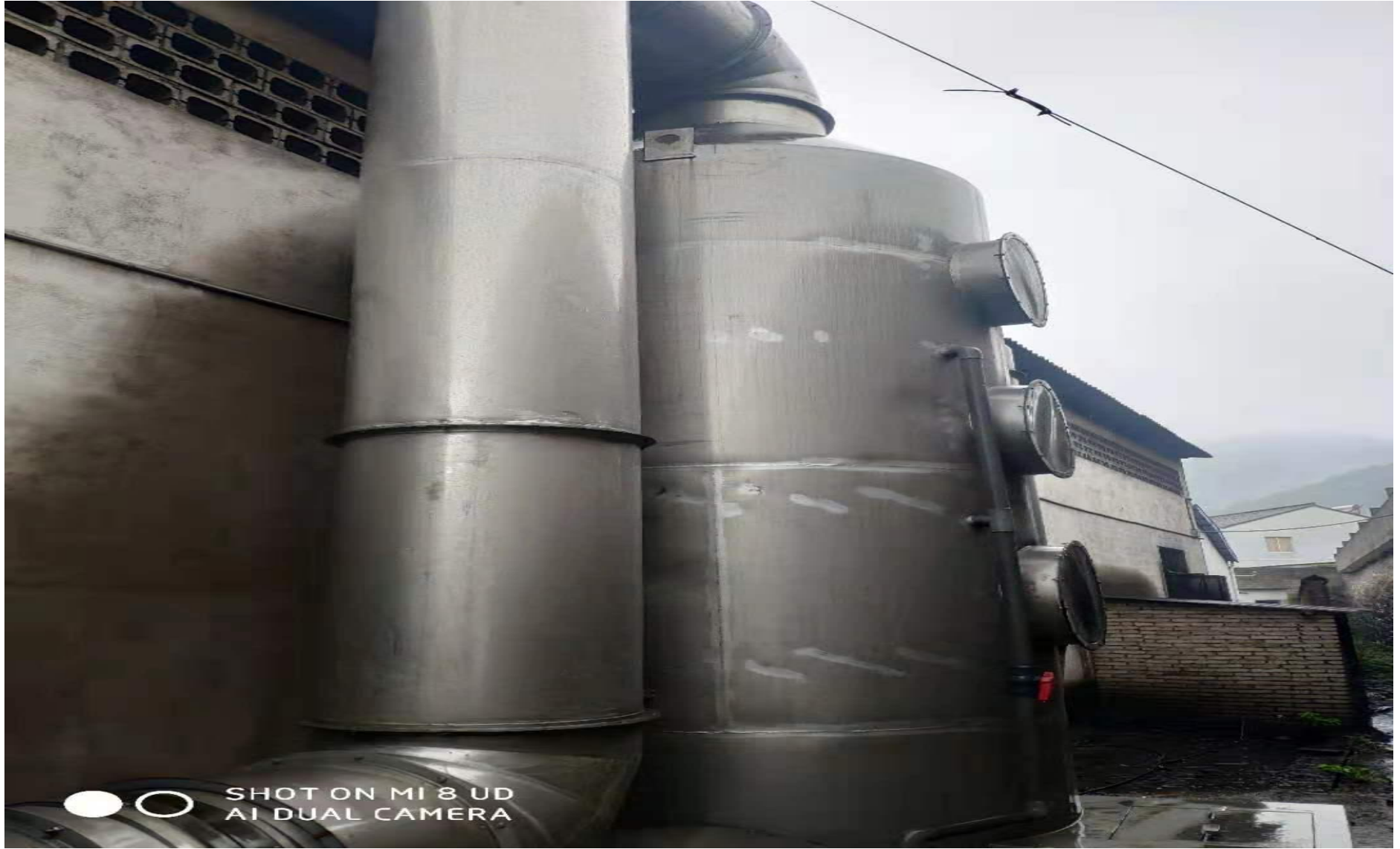
熔化、燃气废气治理设施（水喷淋）
