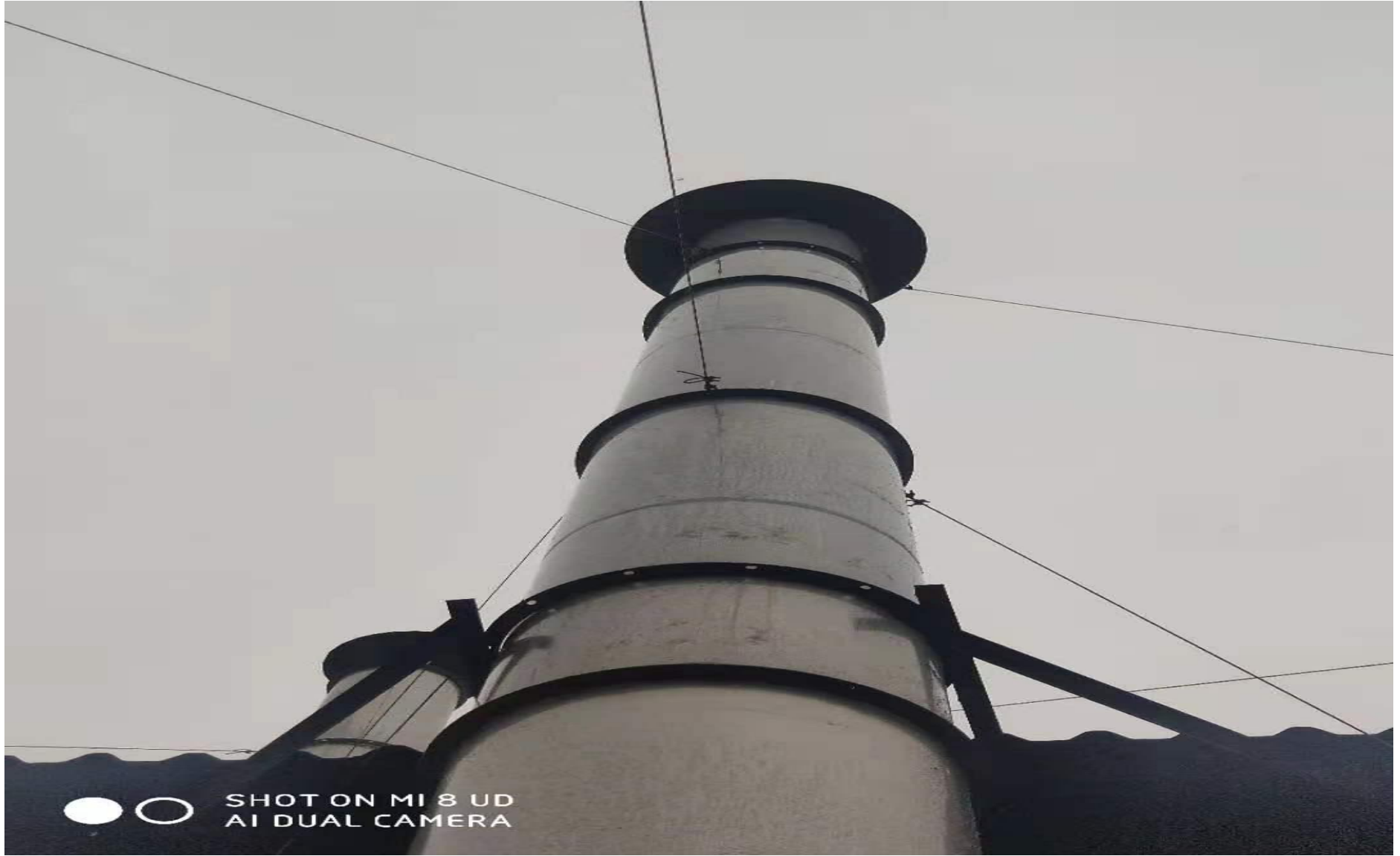
熔化、燃气废气排气筒出口
