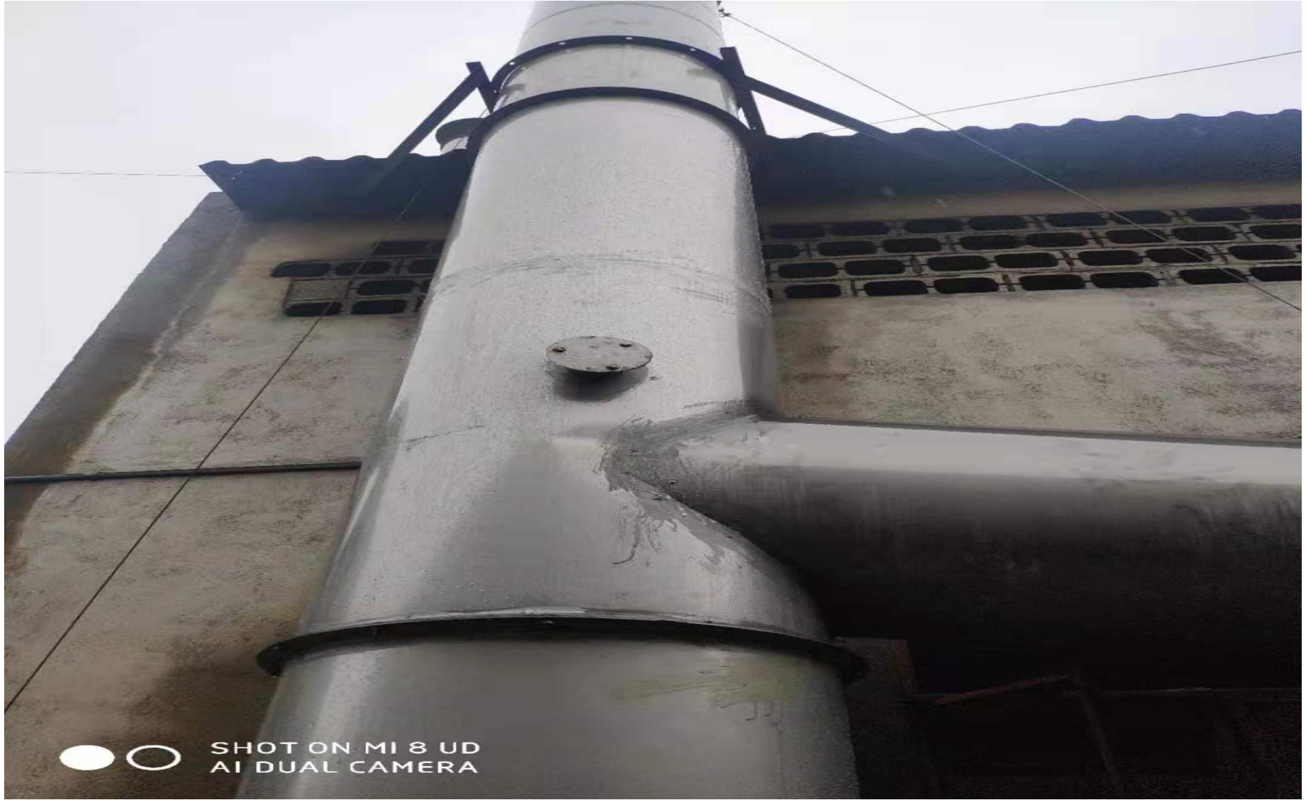
熔化、燃气废气采样口
