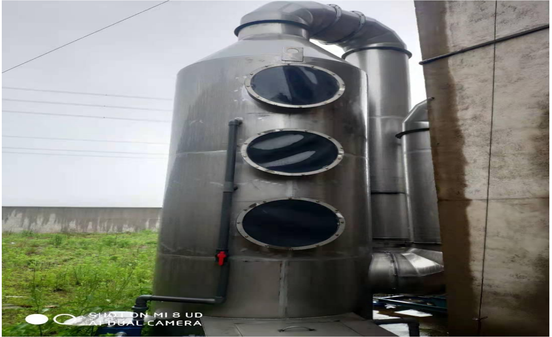
脱模废气治理设施（水喷淋）
