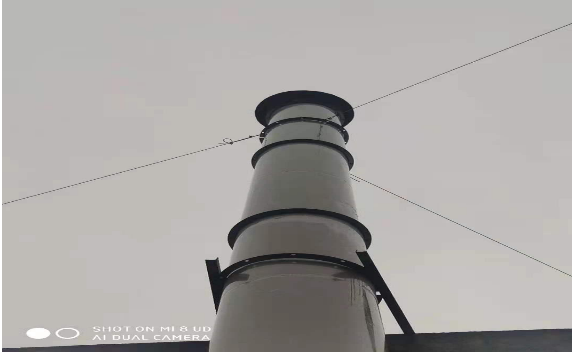
脱模废气排气筒出口
