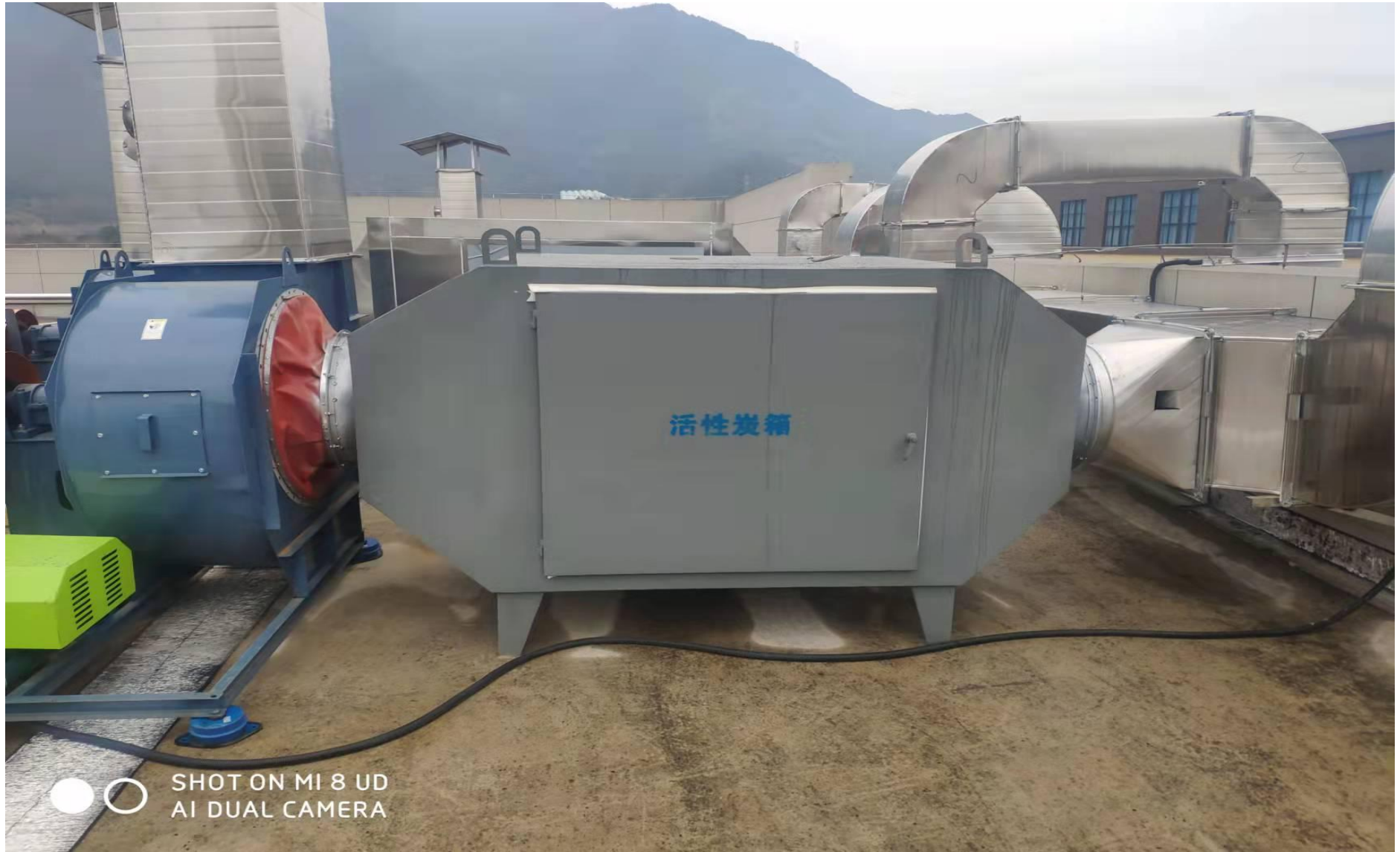
移印废气治理设施（活性炭吸附）
