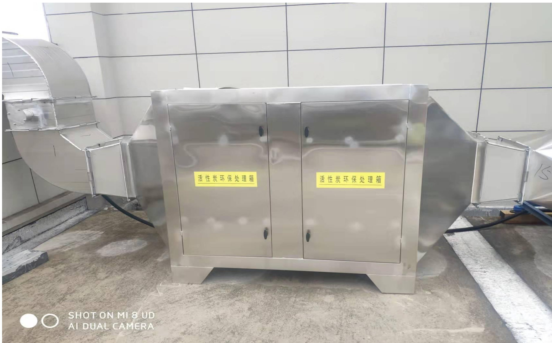
制版废气治理设施（活性炭吸附）
