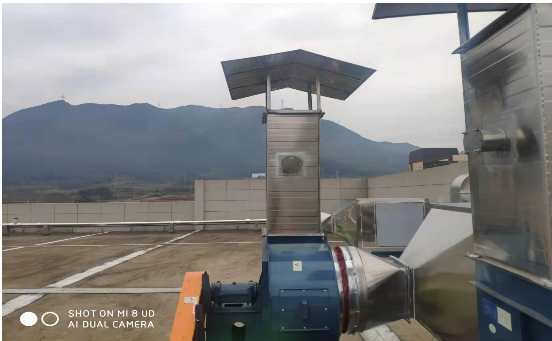
2#注塑废气出口采样口及排气筒出口
