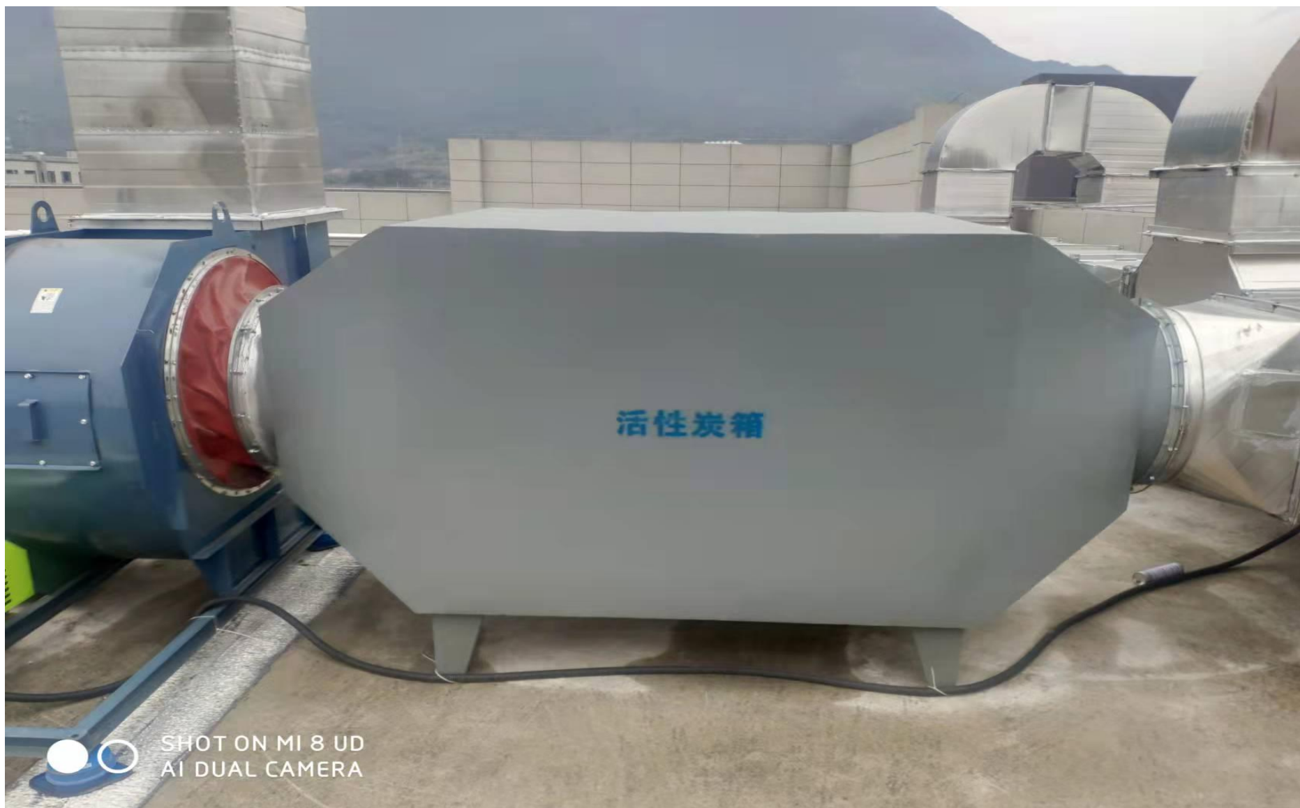
丝印废气治理设施（活性炭吸附）
