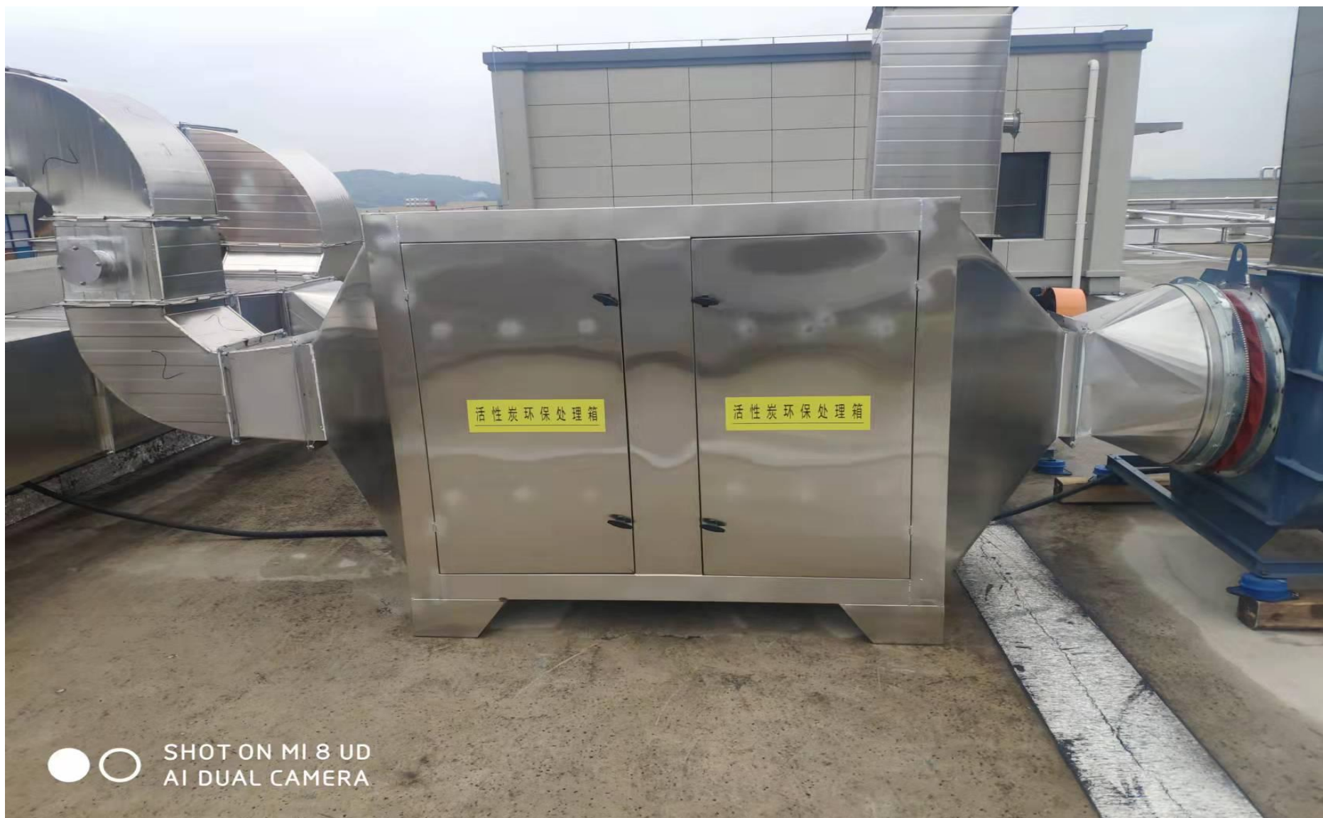
2#注塑废气治理设施（活性炭吸附）
