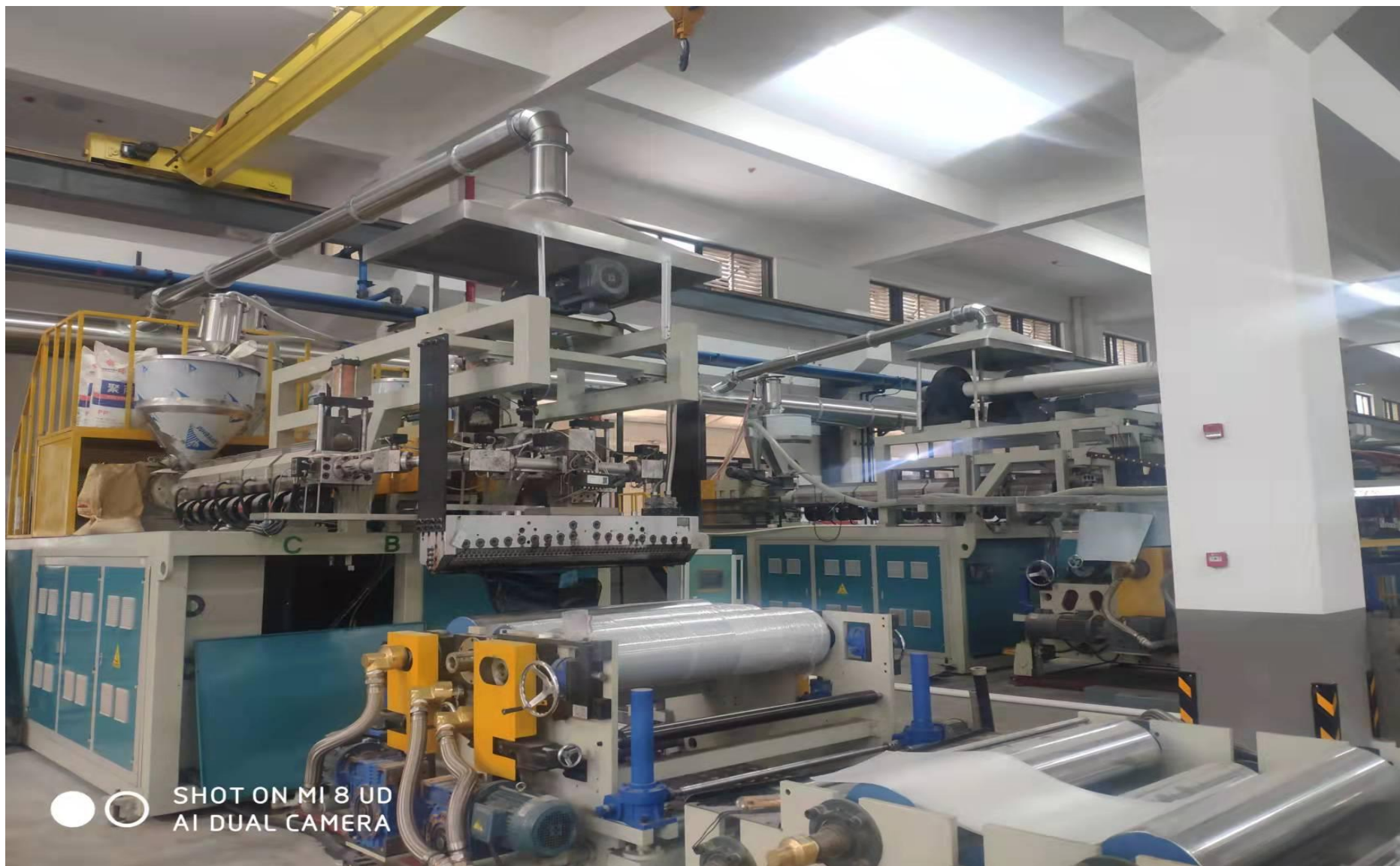
制版废气产生源及收集装置
