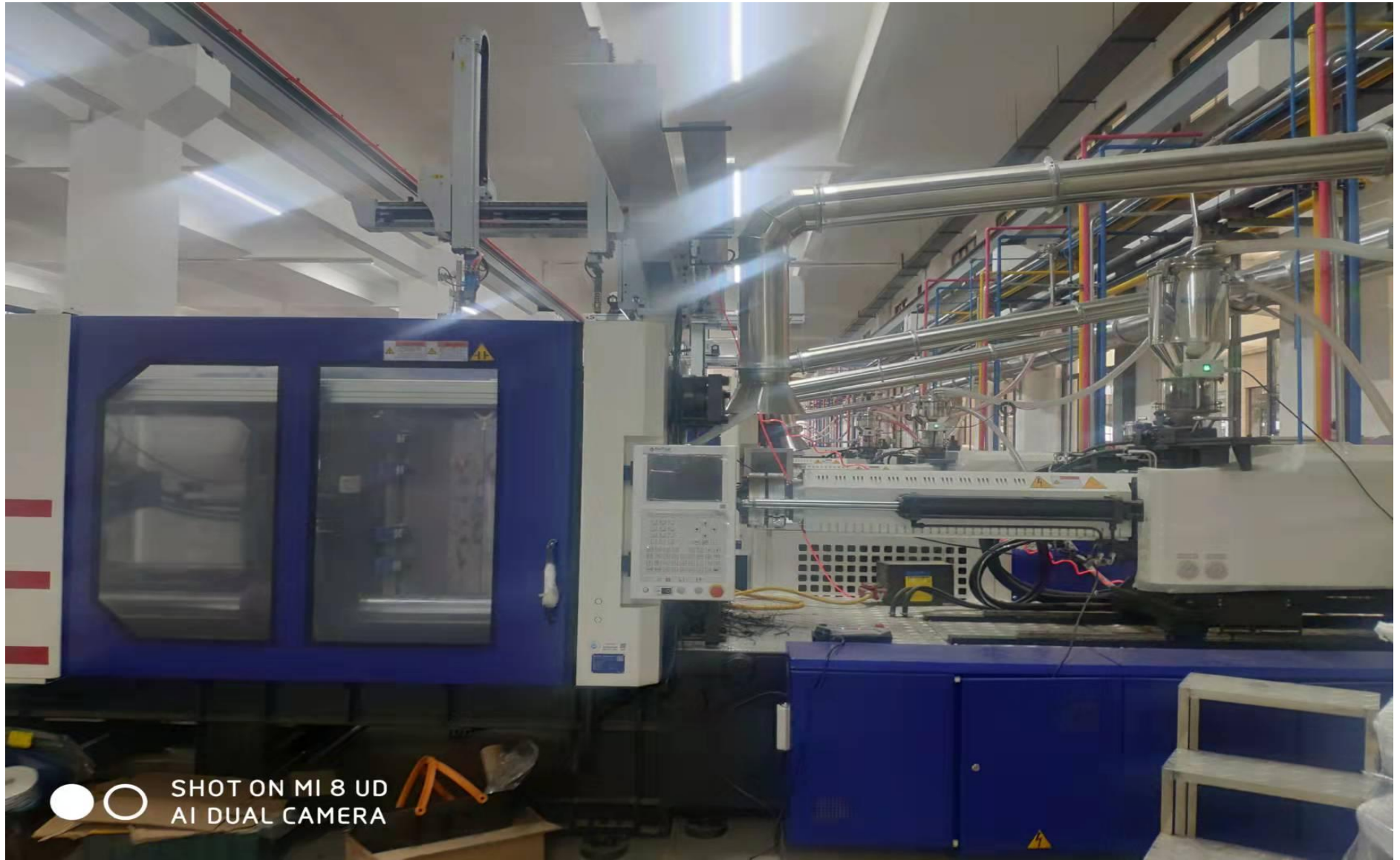
3#注塑废气产生源及收集装置
