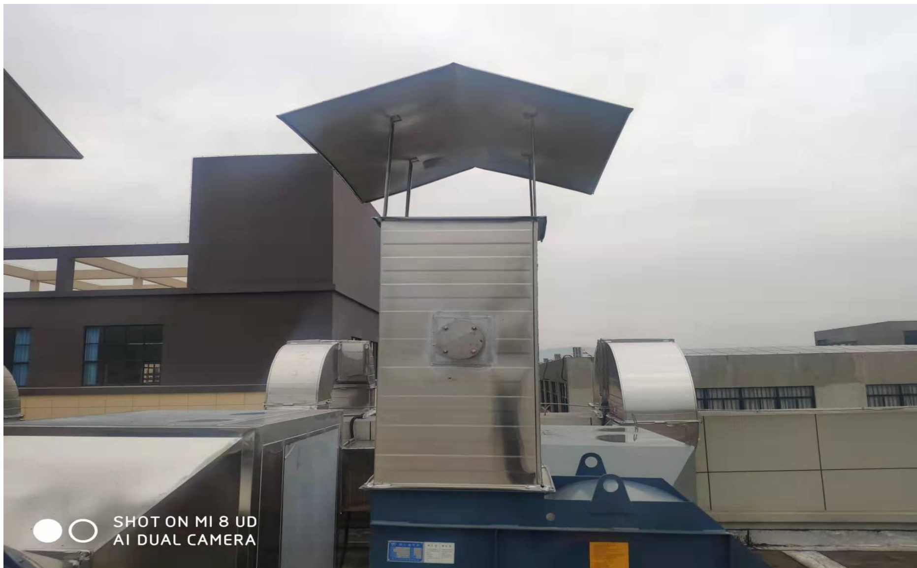
移印废气出口采样口及排气筒出口
