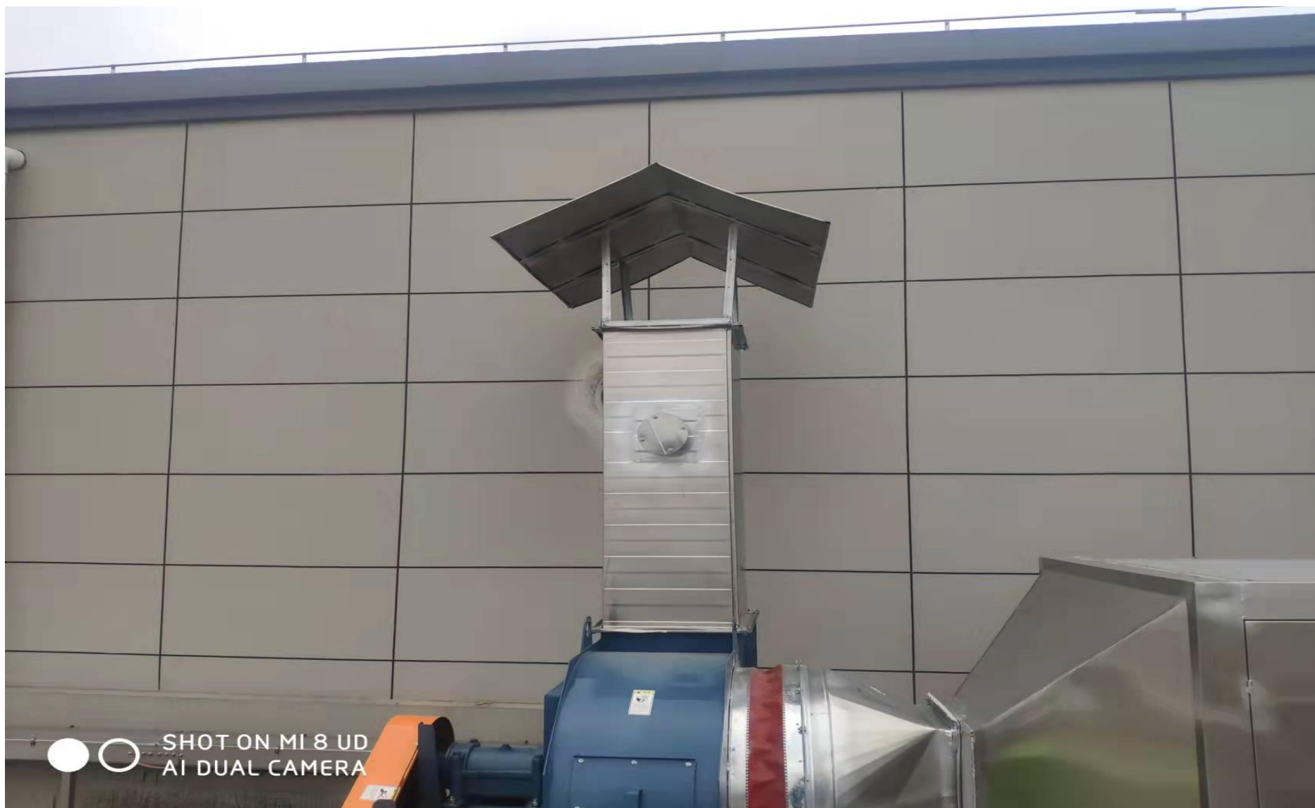
3#注塑废气出口采样口及排气筒出口
