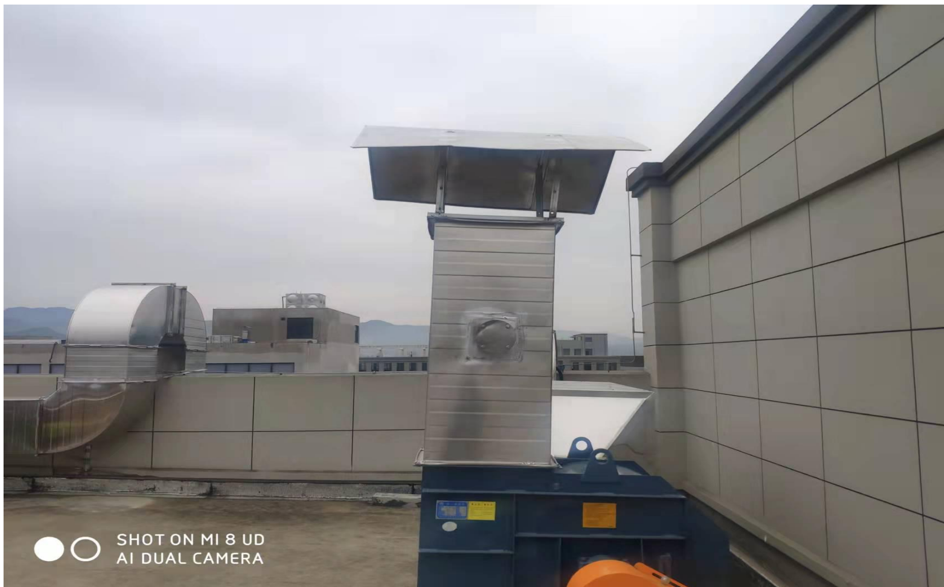
制版废气出口采样口及排气筒出口
