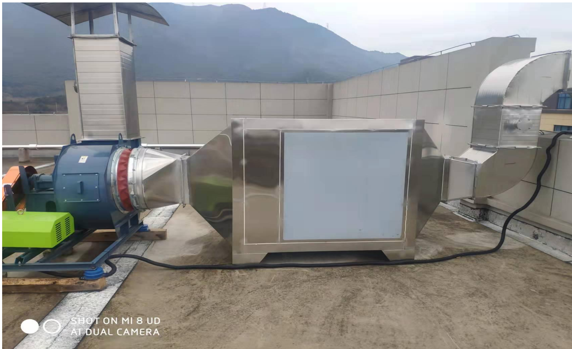
1#注塑废气治理设施（活性炭吸附）
