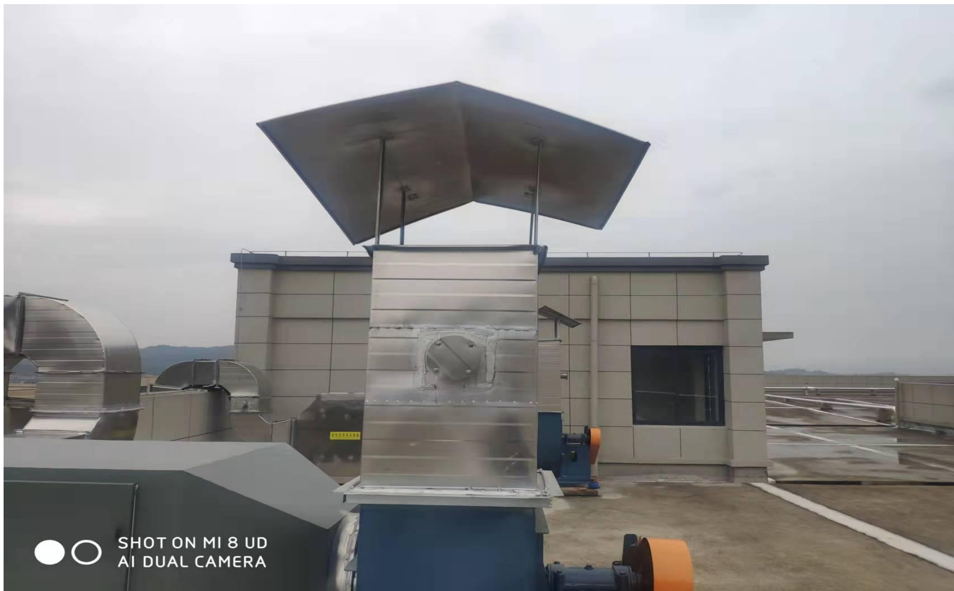
丝印废气出口采样口及排气筒出口
