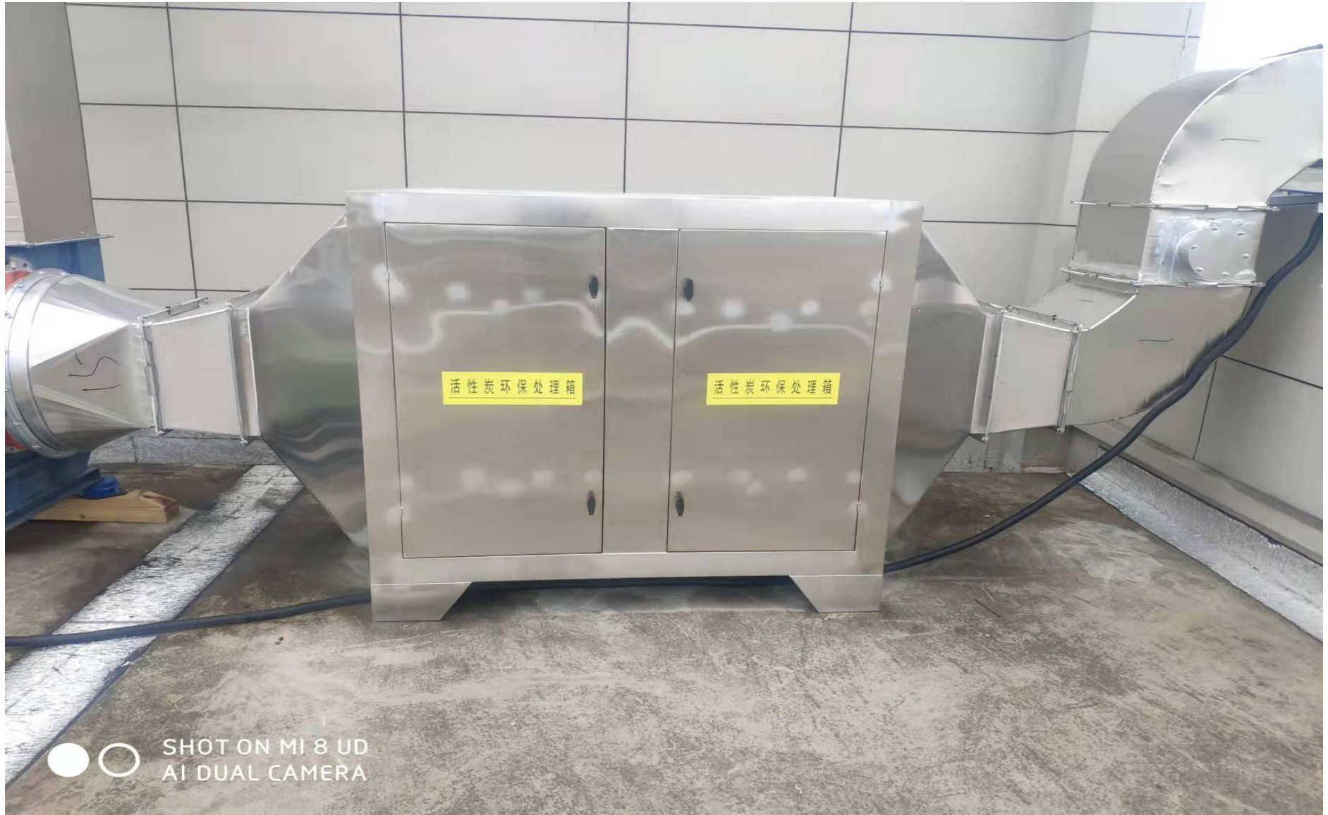
吹膜废气治理设施（活性炭吸附）
