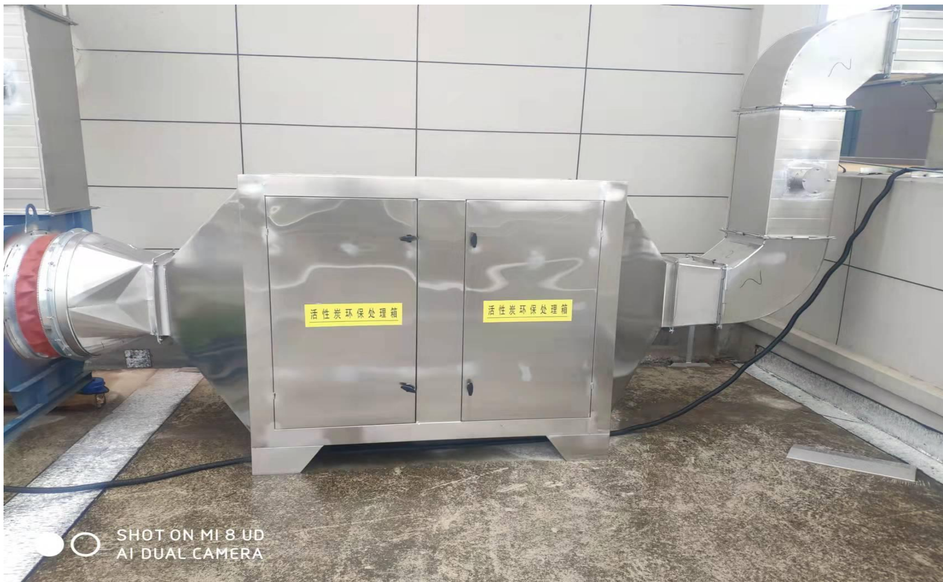
3#注塑废气治理设施（活性炭吸附）
