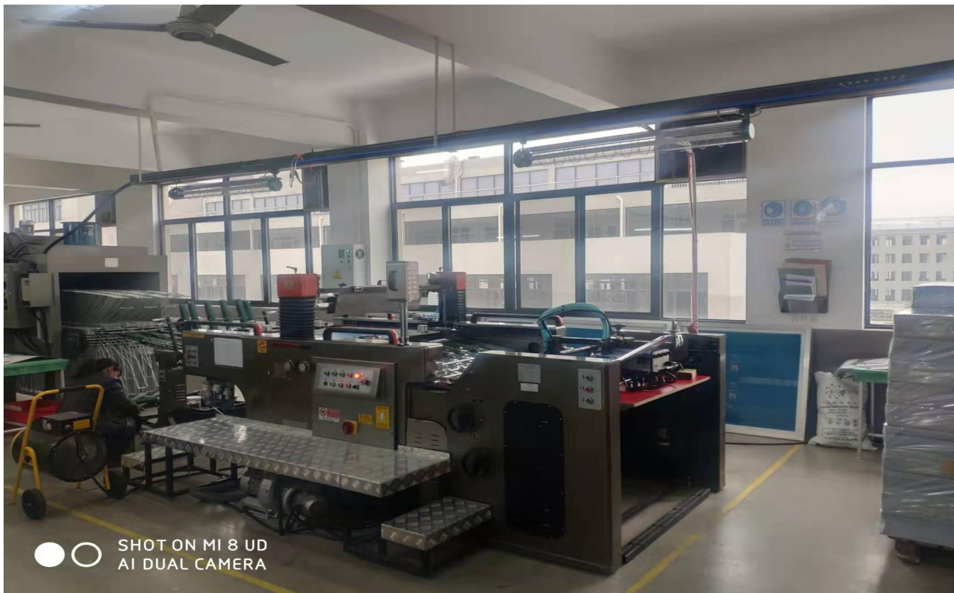
丝印废气产生源及收集装置
