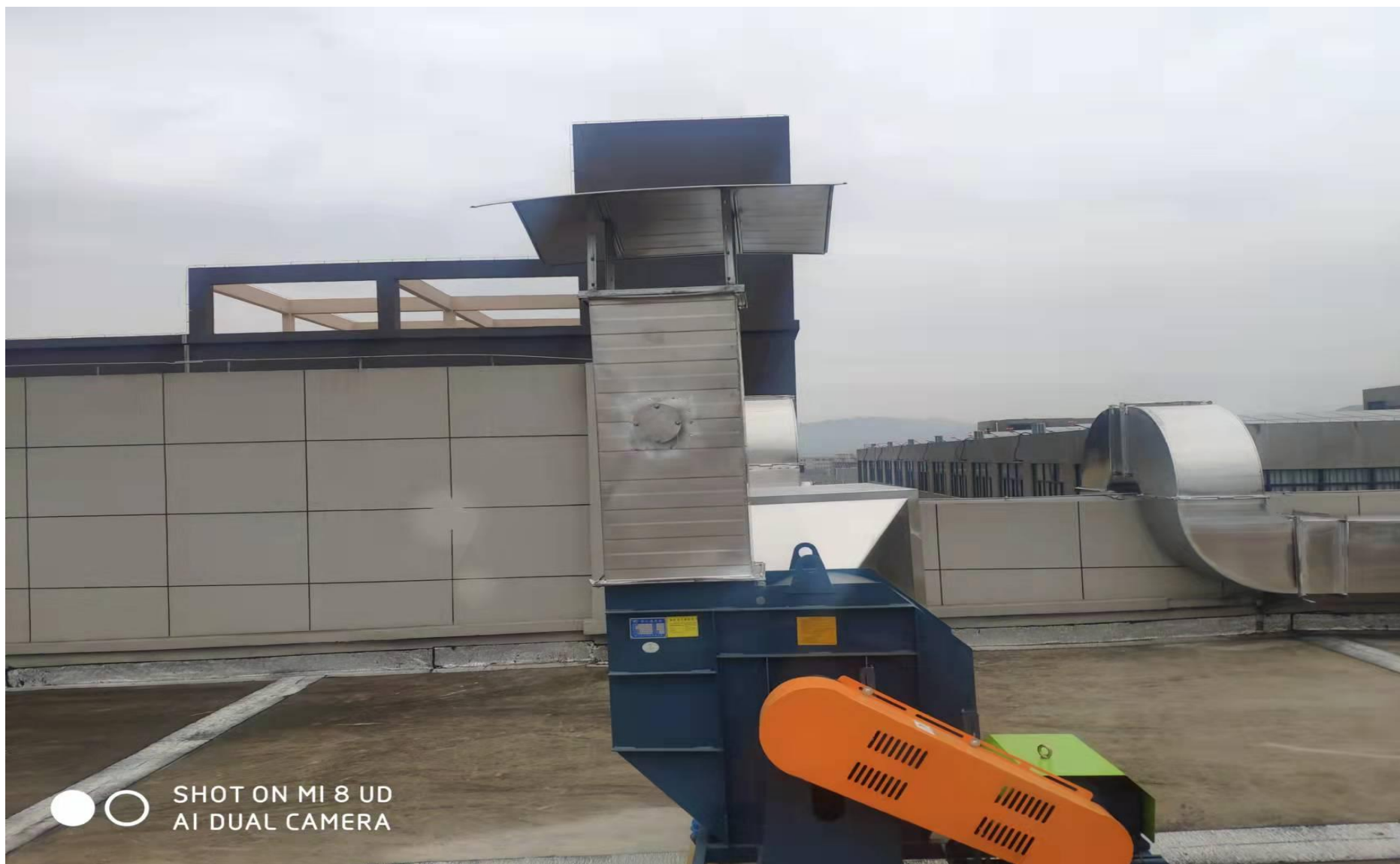
1#注塑废气出口采样口及排气筒出口
