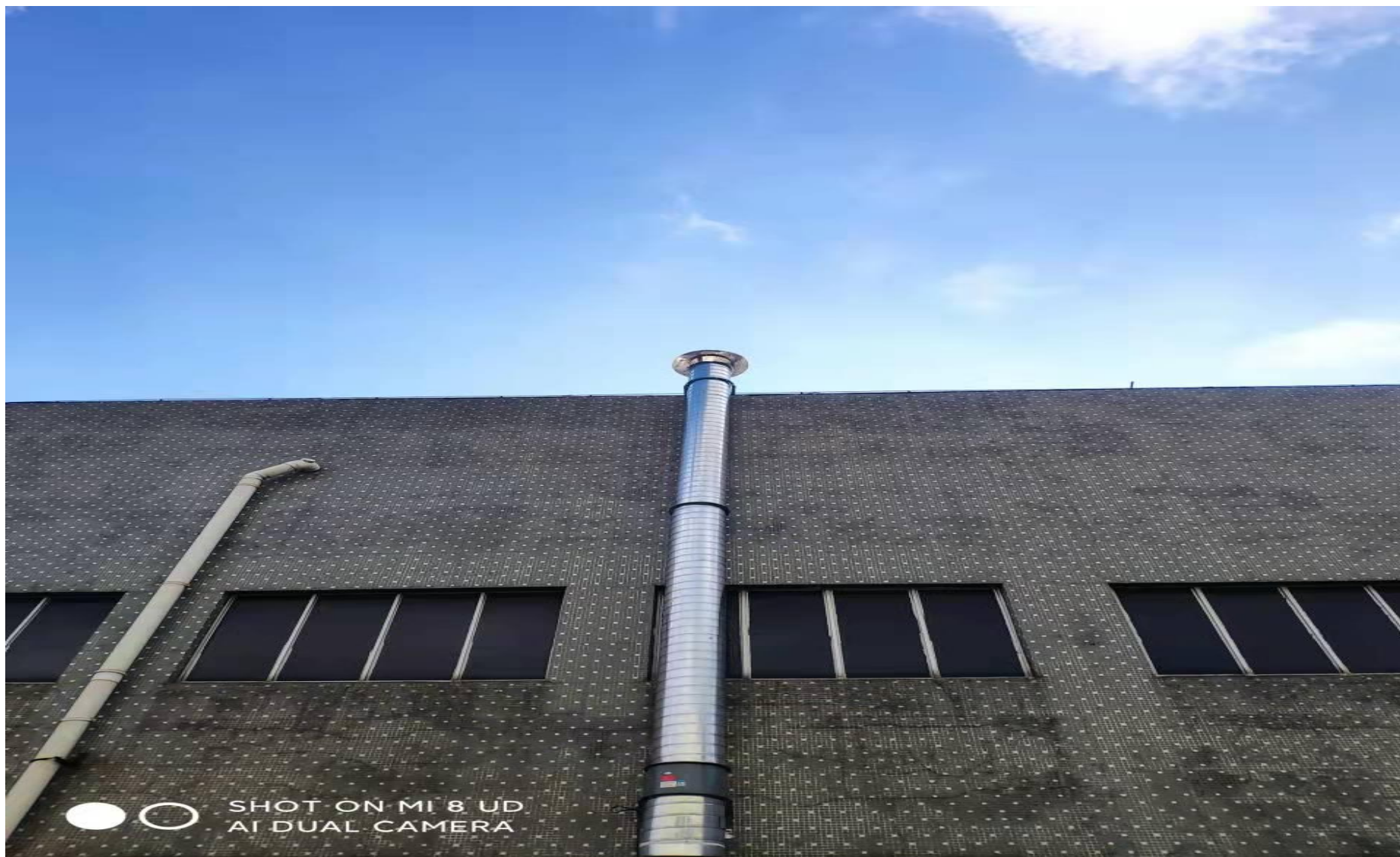
注塑燃气废气排气筒出口
