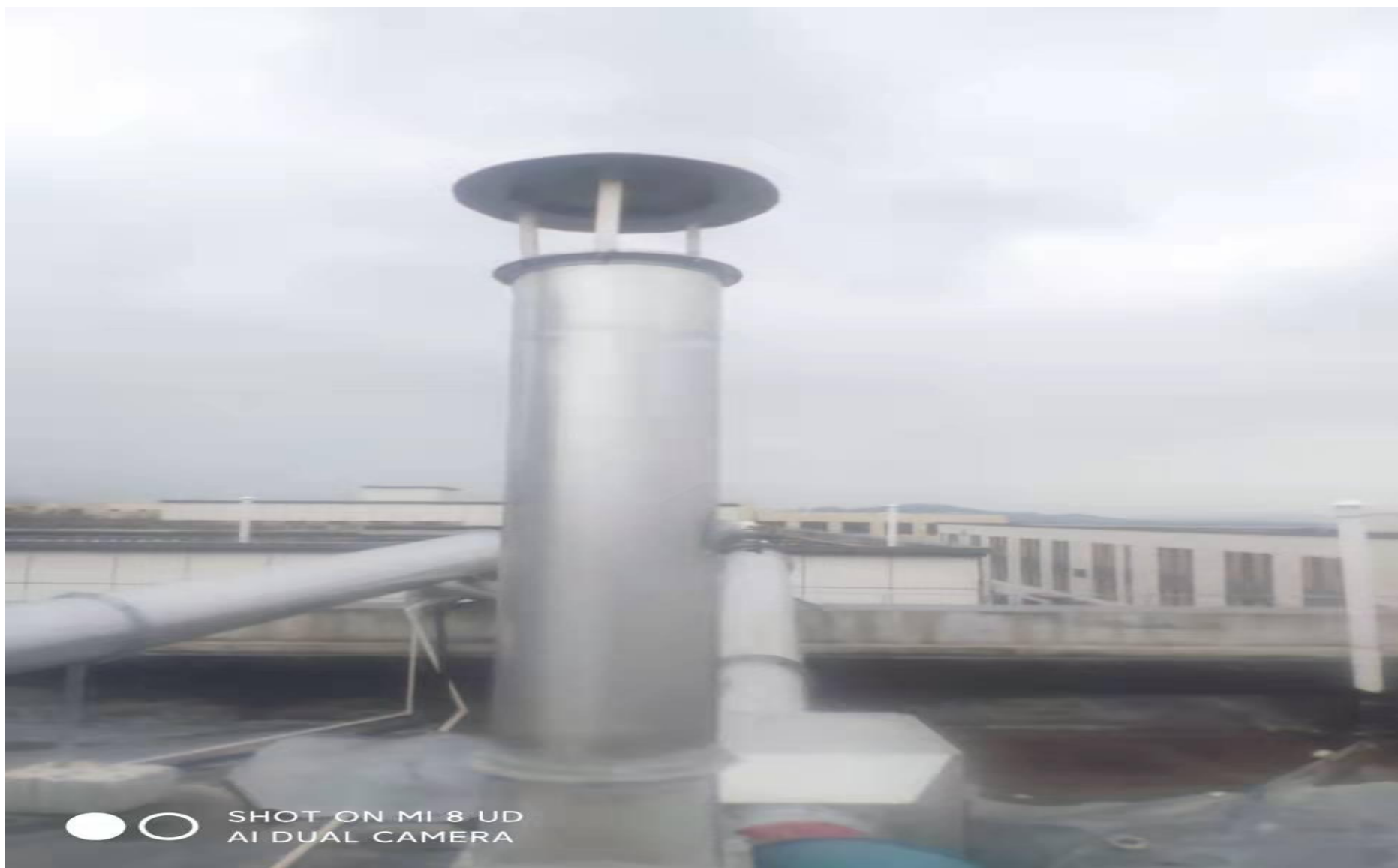
开炼、烘烤废气排气筒出口
