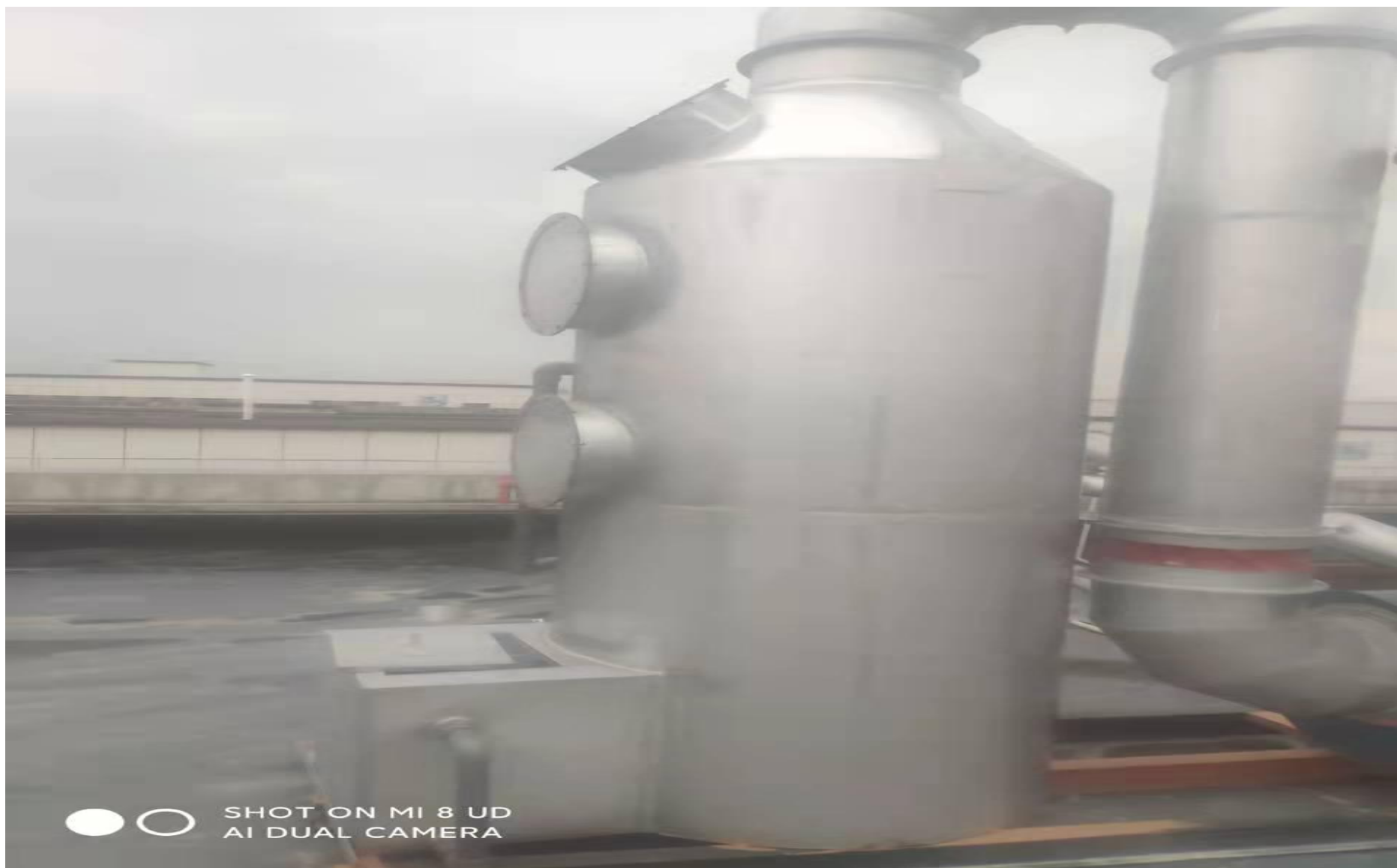
滚喷废气治理设施（水喷淋）
