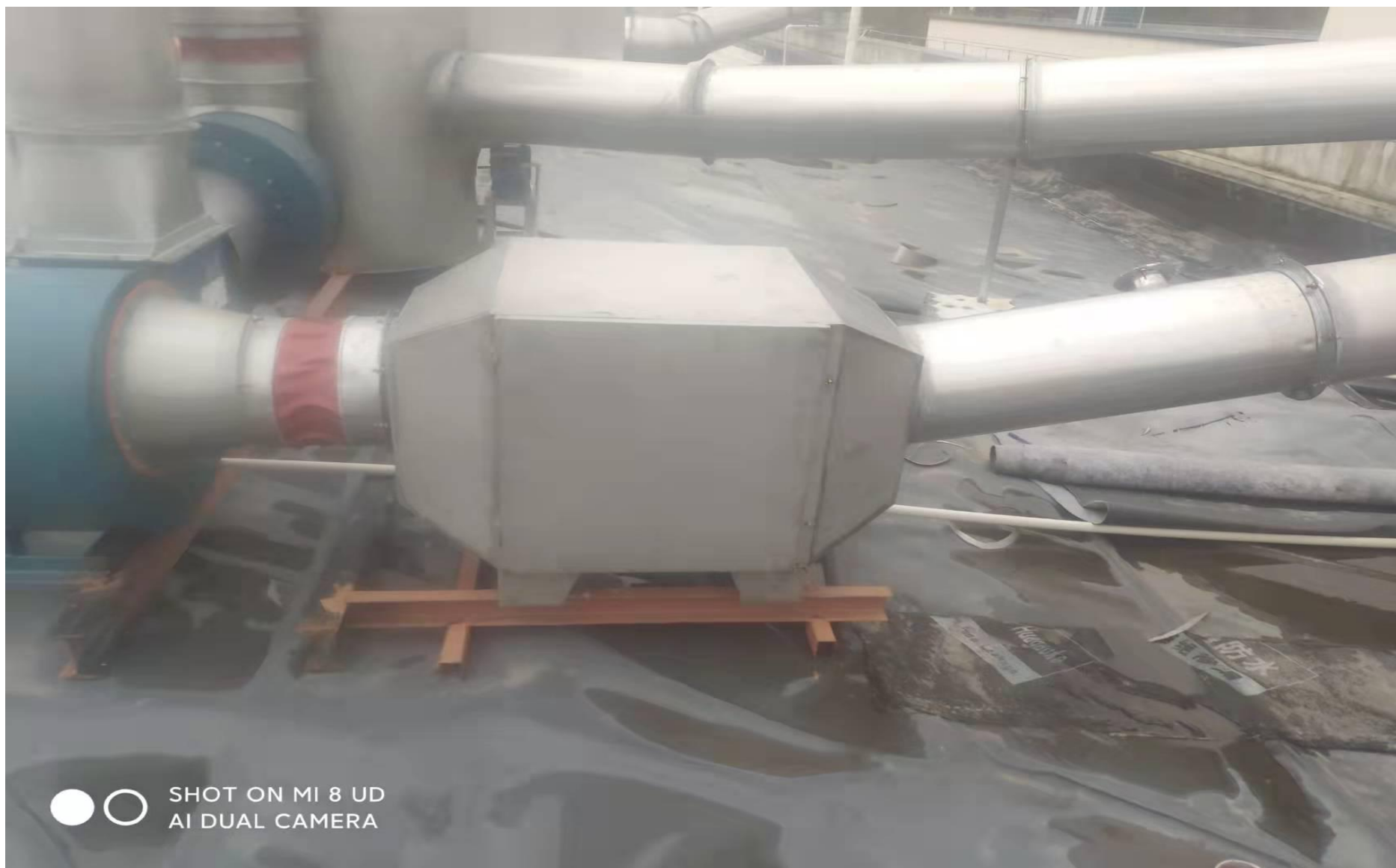
开炼废气、烘烤废气治理设施（活性炭吸附）
