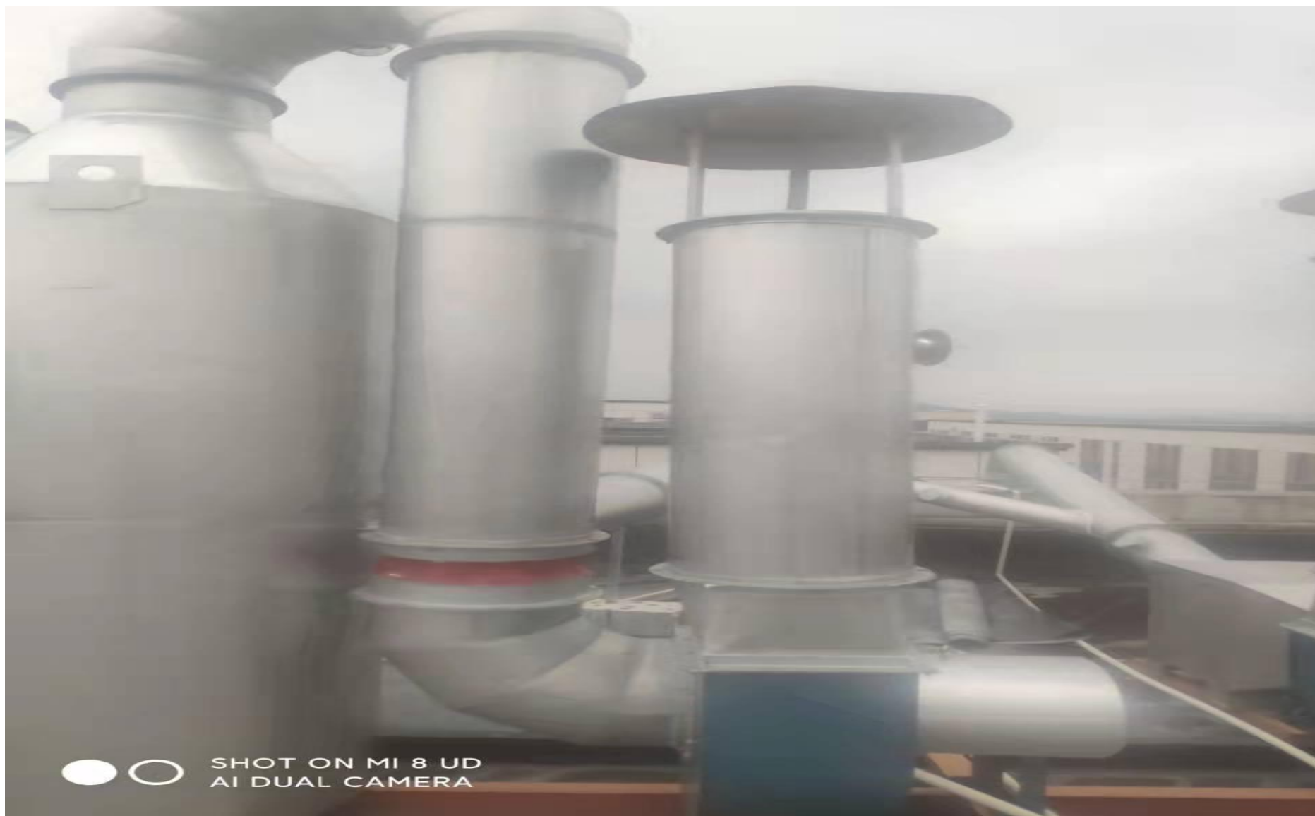
滚喷废气排气筒出口
