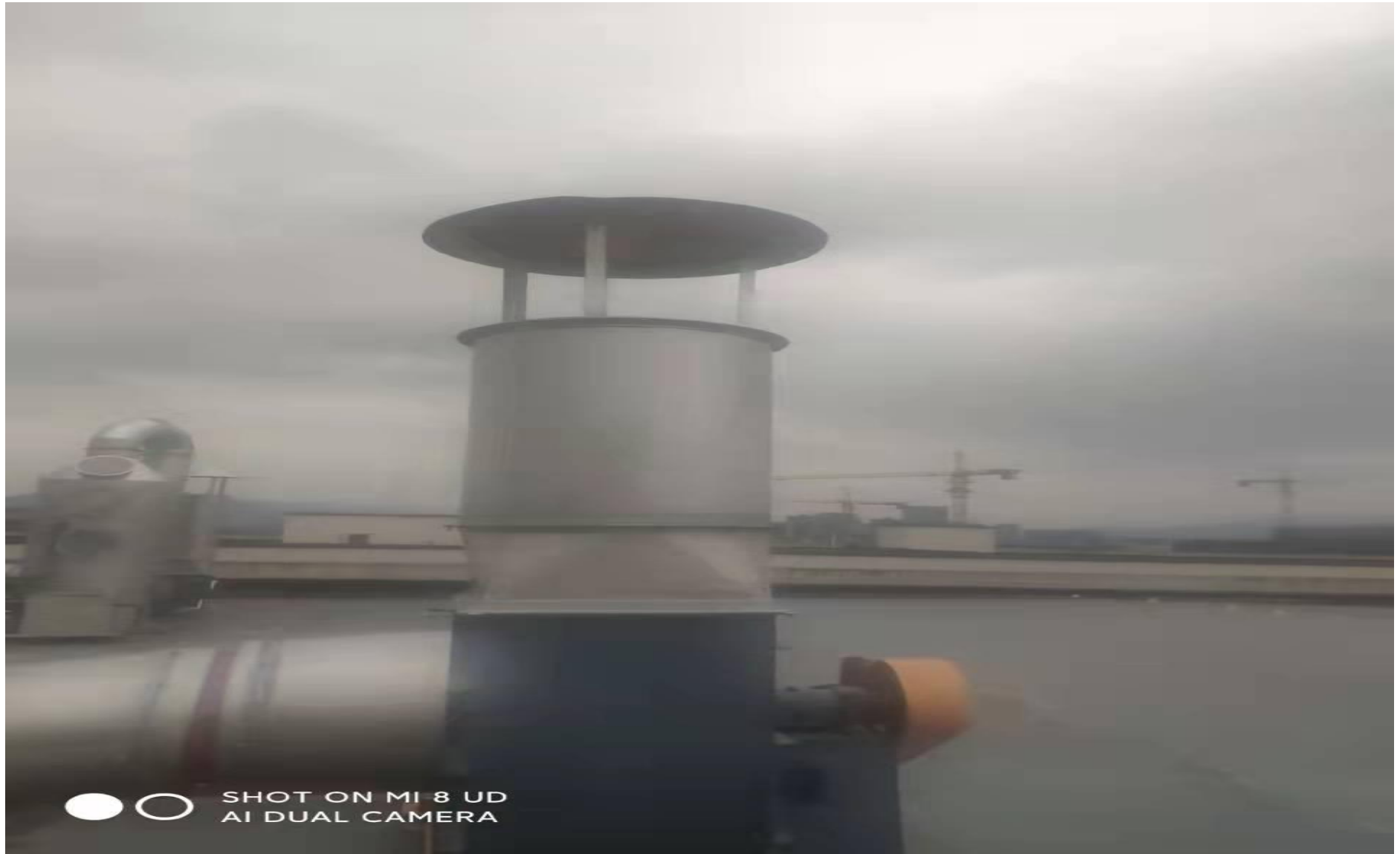
硫化废气排气筒出口
