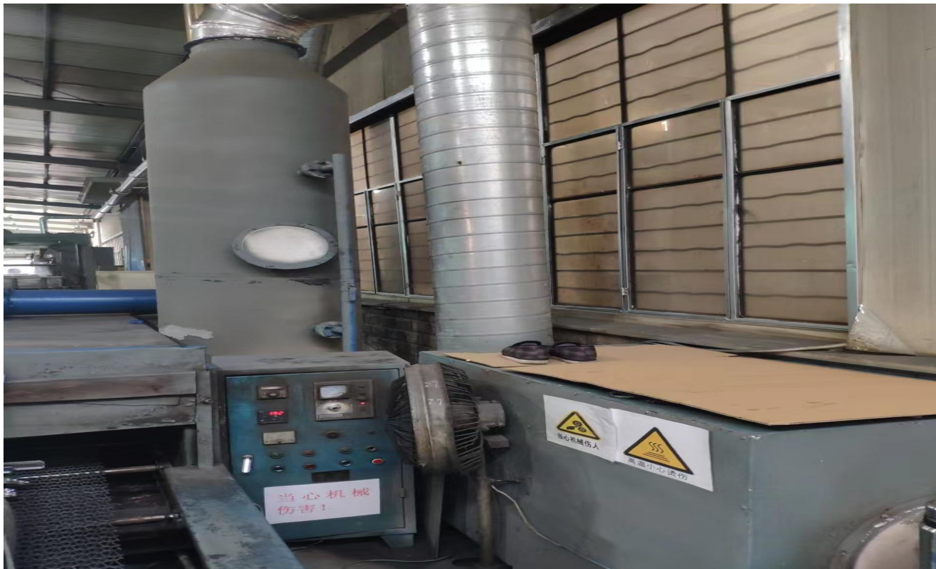
柴油燃烧废气处理设施（水喷淋+过滤网+活性炭吸附+光氧催化装置）
