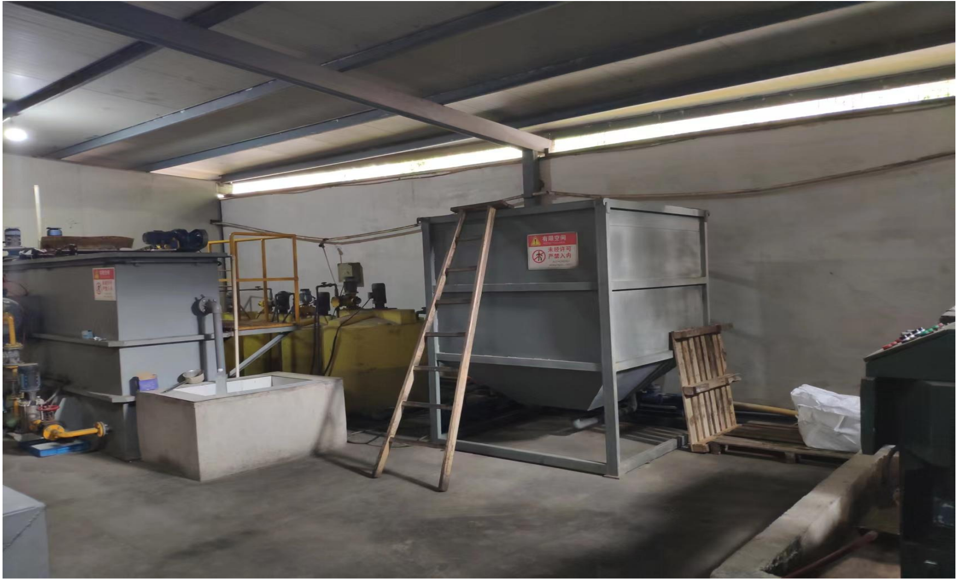
污水处理设施
