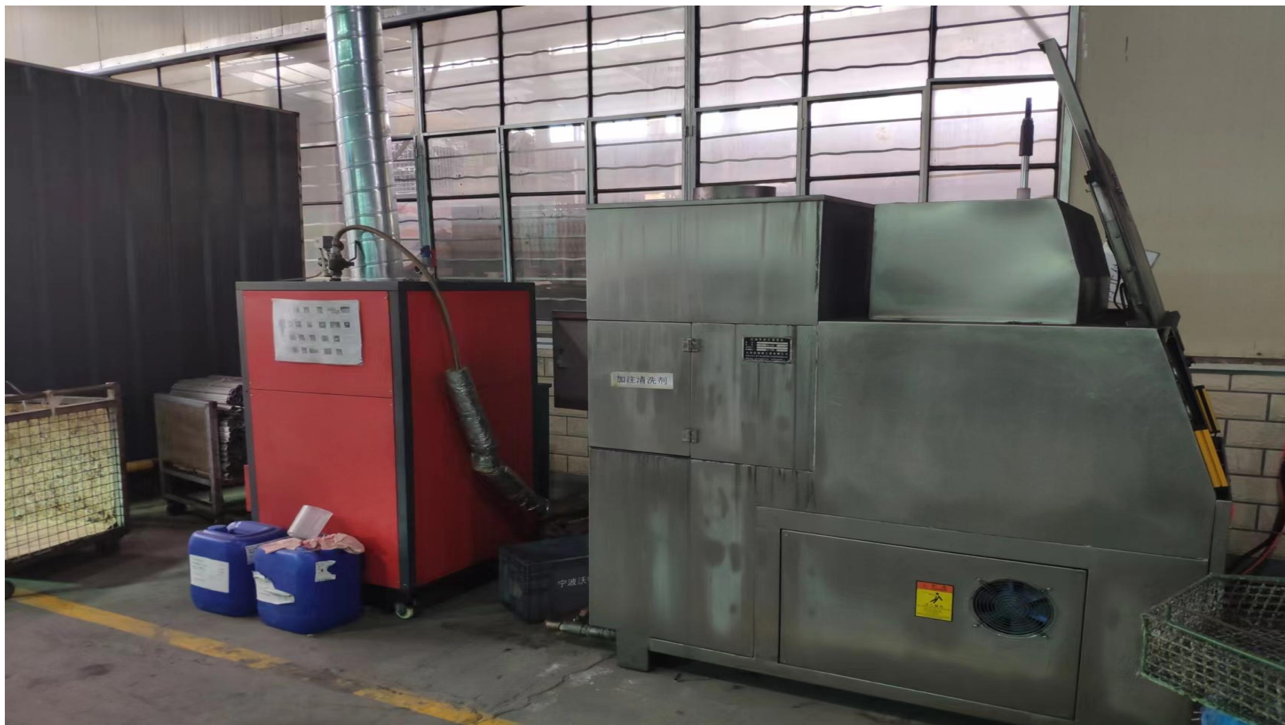
柴油燃烧废气产生源及收集装置（密闭收集）
