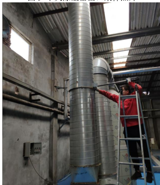
图 7 废气处理设施出口采样照片
