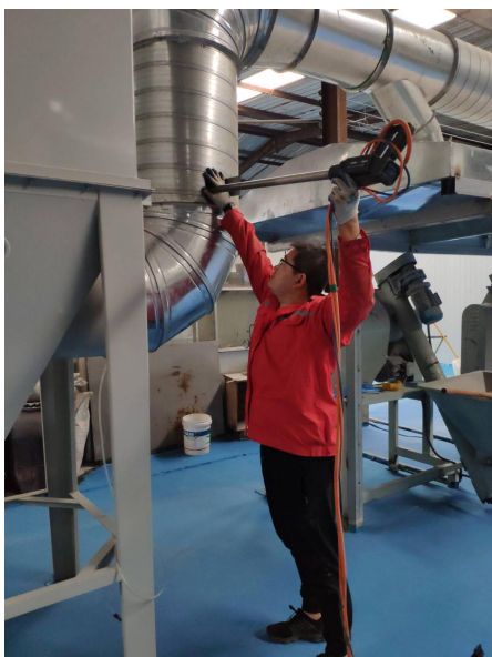
图 4 中央除尘器进口采样照片
