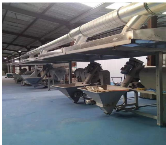
项目现场生产设备照片
