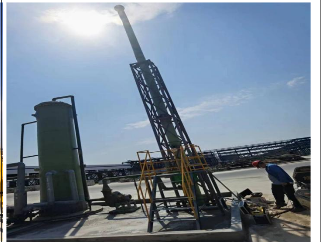
P2-4 废气排气筒
