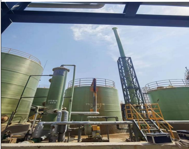
P1-22 废气排气筒
