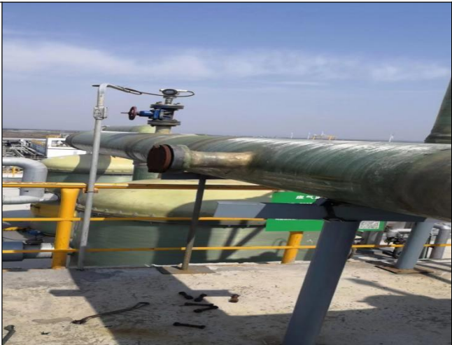
2#二级碱吸收塔
