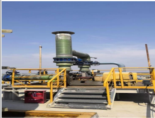
P2-2 废气排气筒
