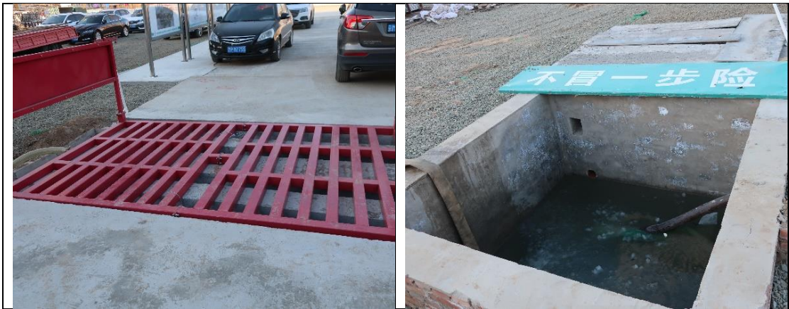
道路广场区洗车设施 (2021.12)
