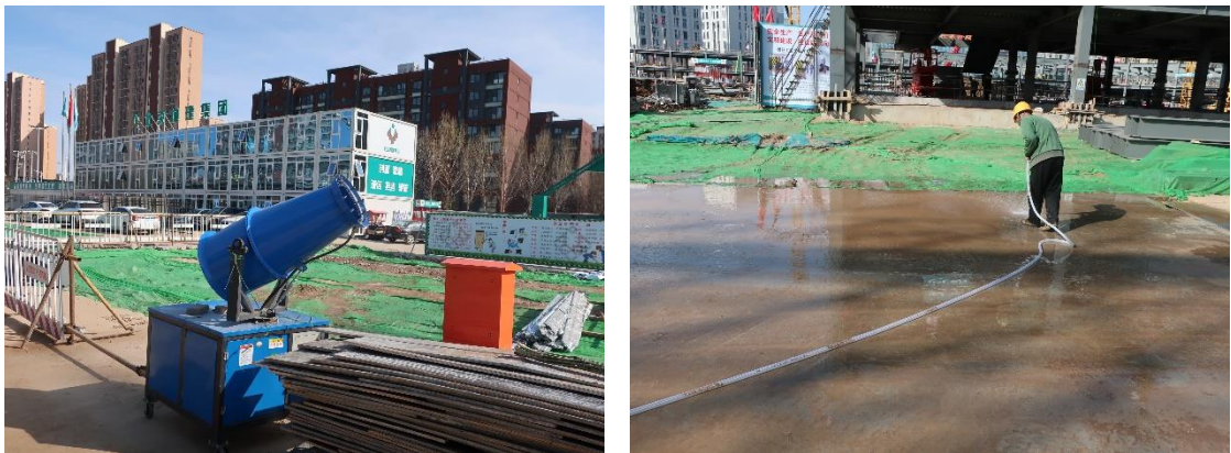
洒水降尘装置 2
