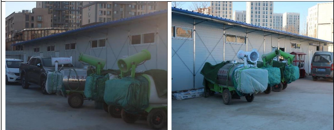
洒水降尘装置 (2021.12)
