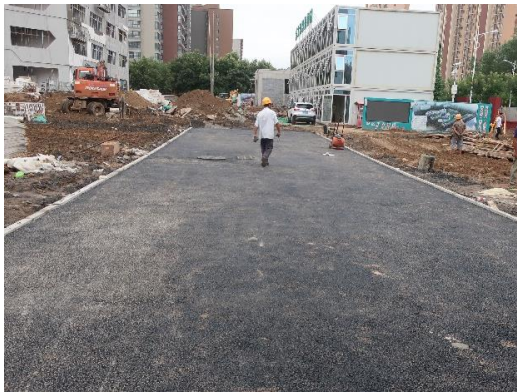
裸露地表临时覆盖不及时现象
