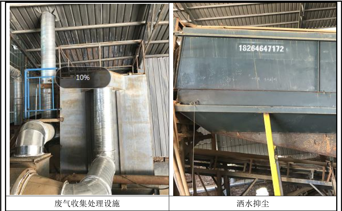
图 4 厂区现状及主要生产、环保设备
