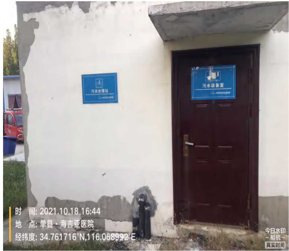
污水处理站照片
