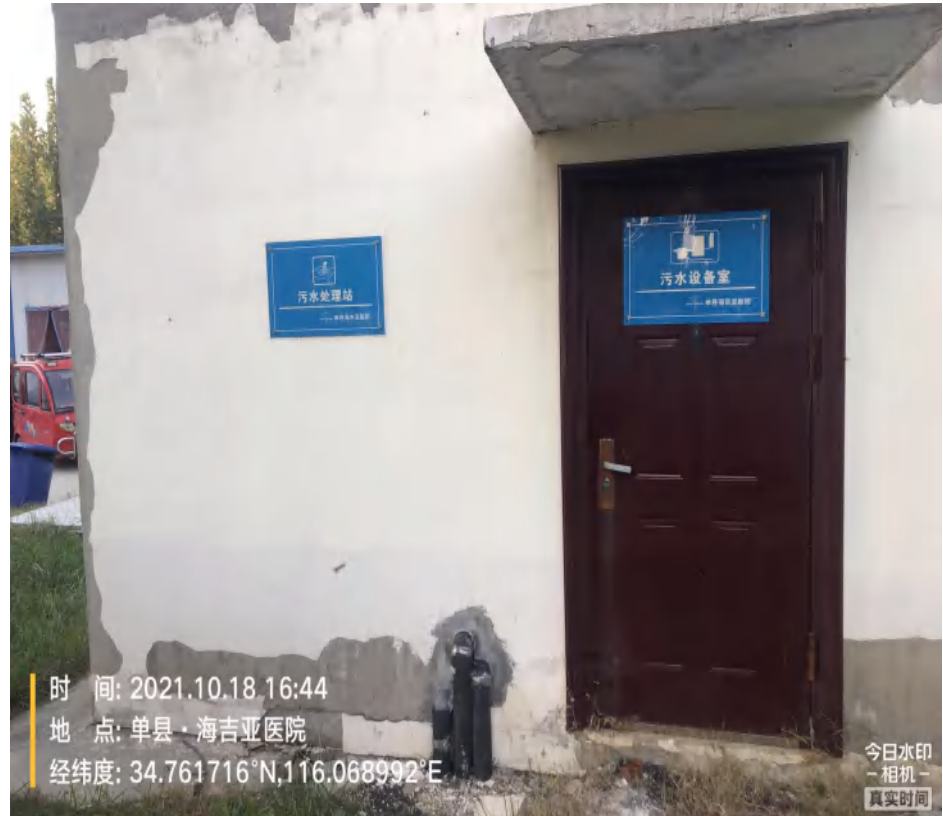
污水处理站照片
