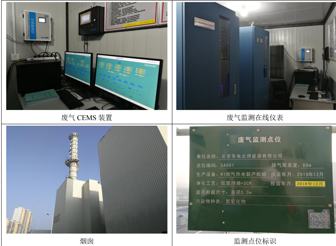
图 4-1 废气防治设施
