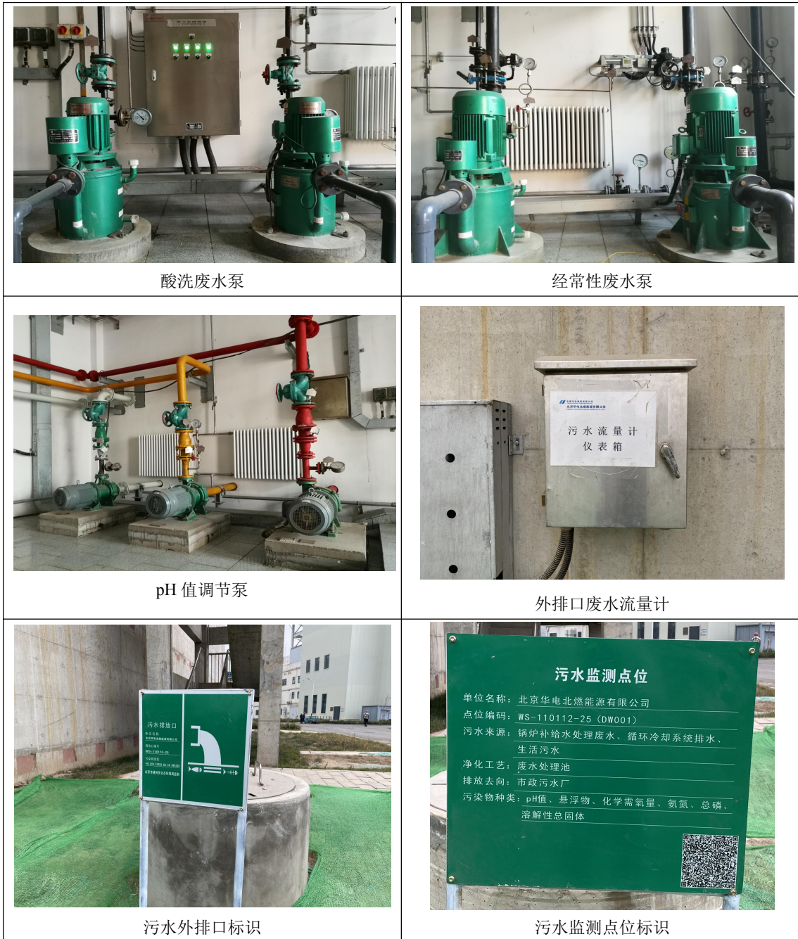
图 4-2 废水治理设施
