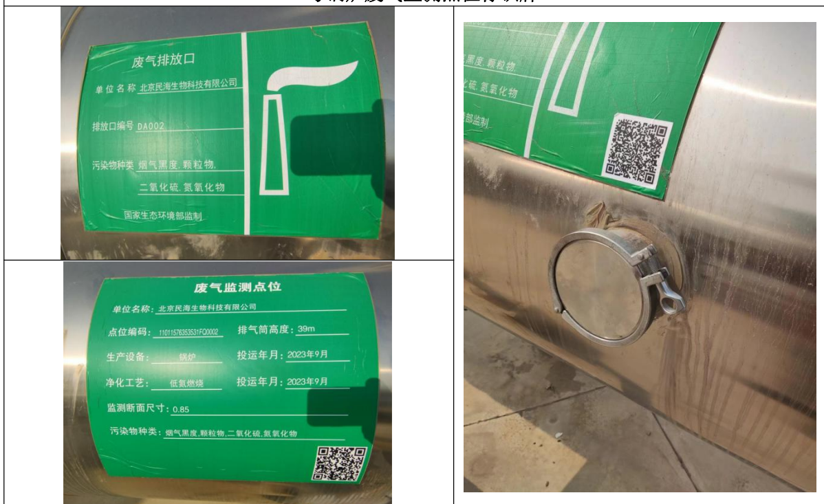
2号锅炉废气监测点位标识牌
