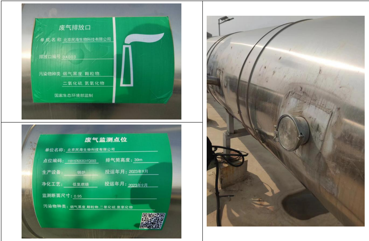
3号锅炉废气监测点位标识牌
