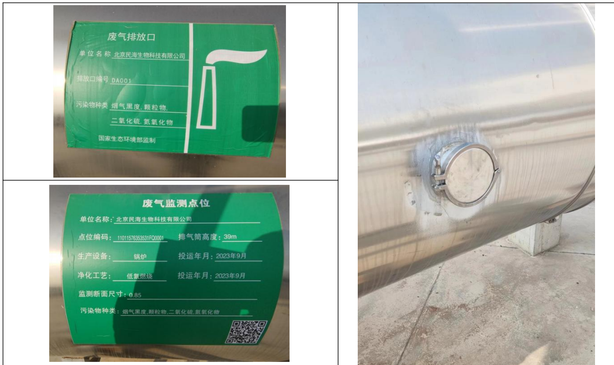
1号锅炉废气监测点位标识牌
