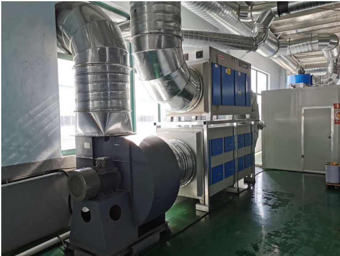
图 4-1 废气处理设备
