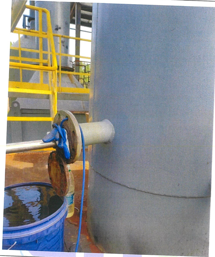
DA001 排气筒采样口©1
