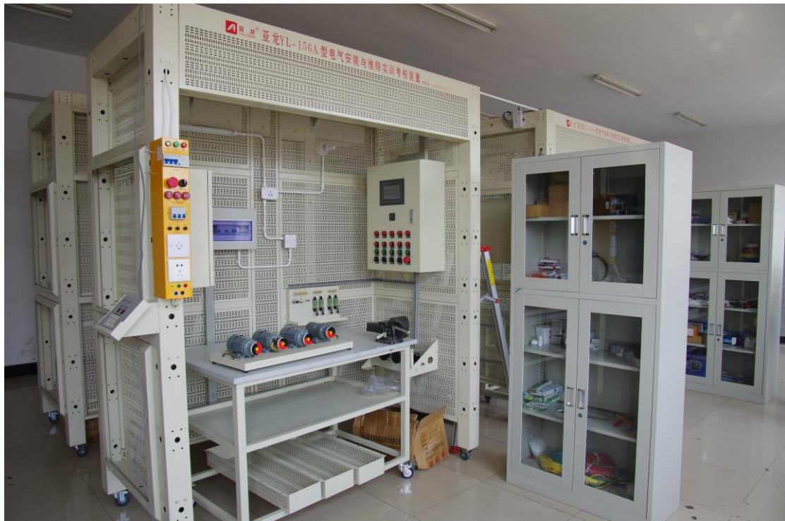
电气安装实训室
