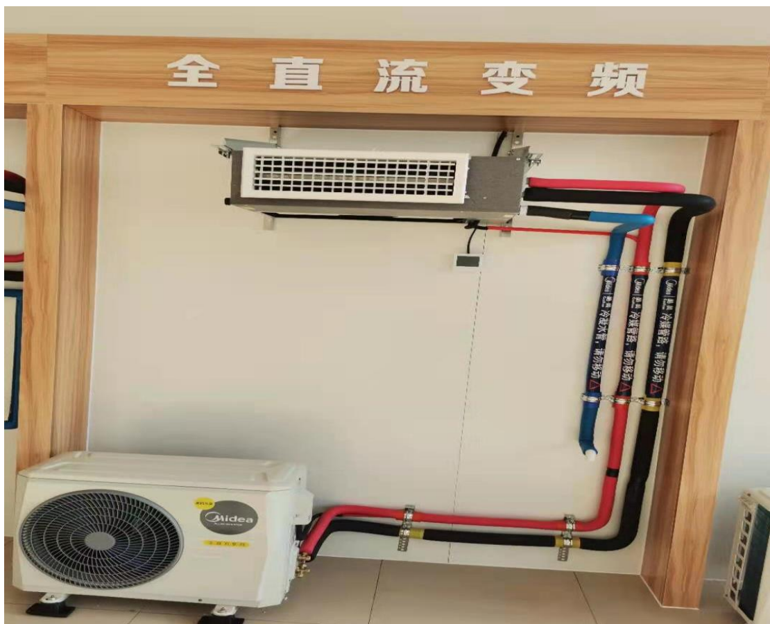
中央空调实训室
