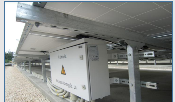
日本JEC 30MW 光伏电站
