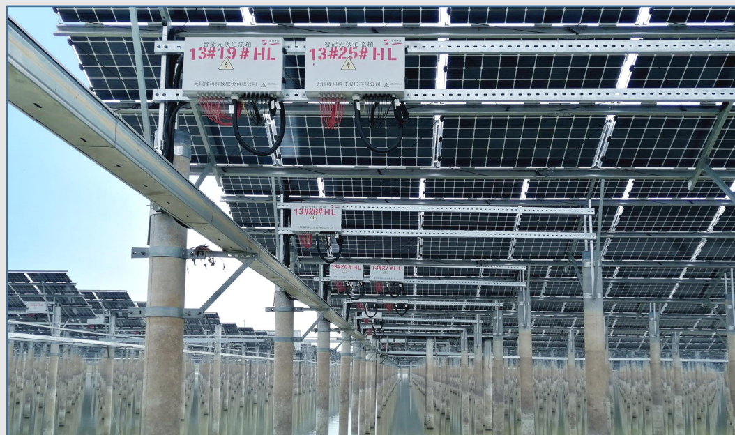
江西上饶鸚鵡湖漁光互補光伏发电250MW项目
