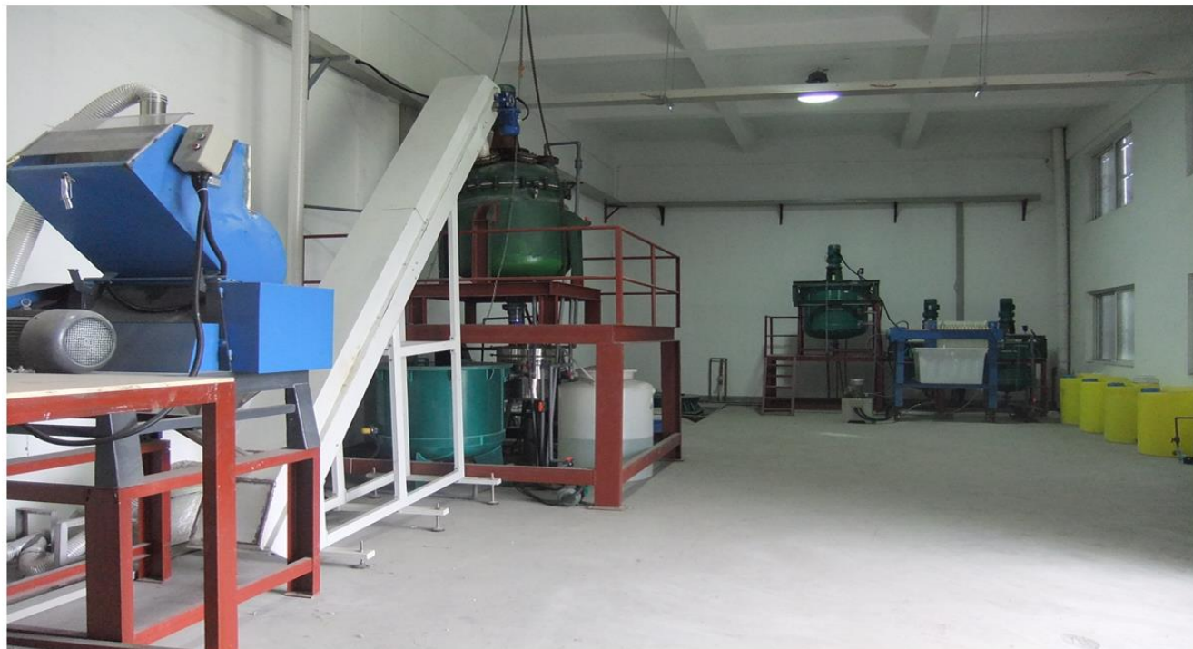
废旧组件回收及原材料再利用生产线
