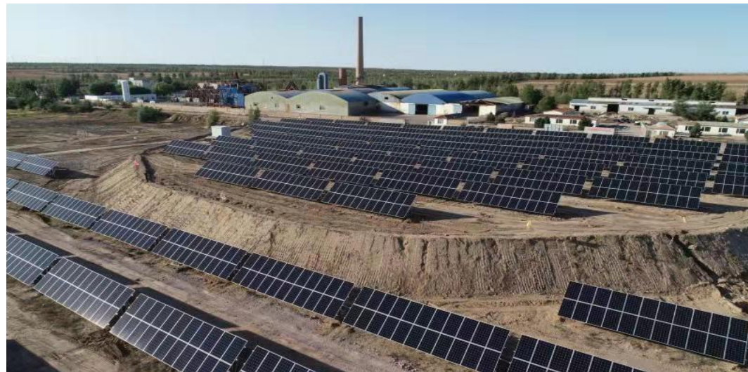
内蒙敖汉旗扶贫电站10.54MW
