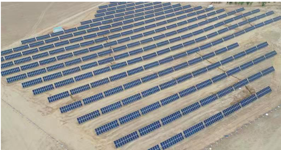
内蒙通辽科左后旗扶贫电站27MW
