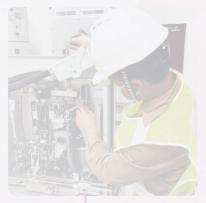
电气综合运维
