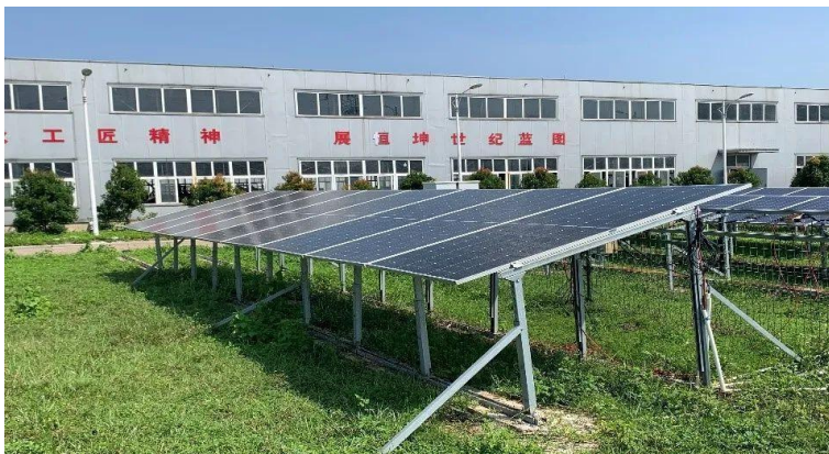
TÜV南德海南实证P型组串
