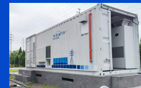
浙江·嘉兴 汽车配件集团公司 光伏2.8MW/储能3MWh
