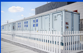
浙江·宁波 新能源材料加工龙头企业 储能30MWh
