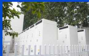
浙江·杭州 空气化工世界500强企业 储能6MWh
