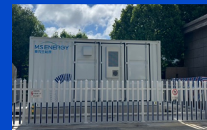
浙江·台州 陶瓷滤芯制造领军企业 光伏0.53MW/储能2MWh
