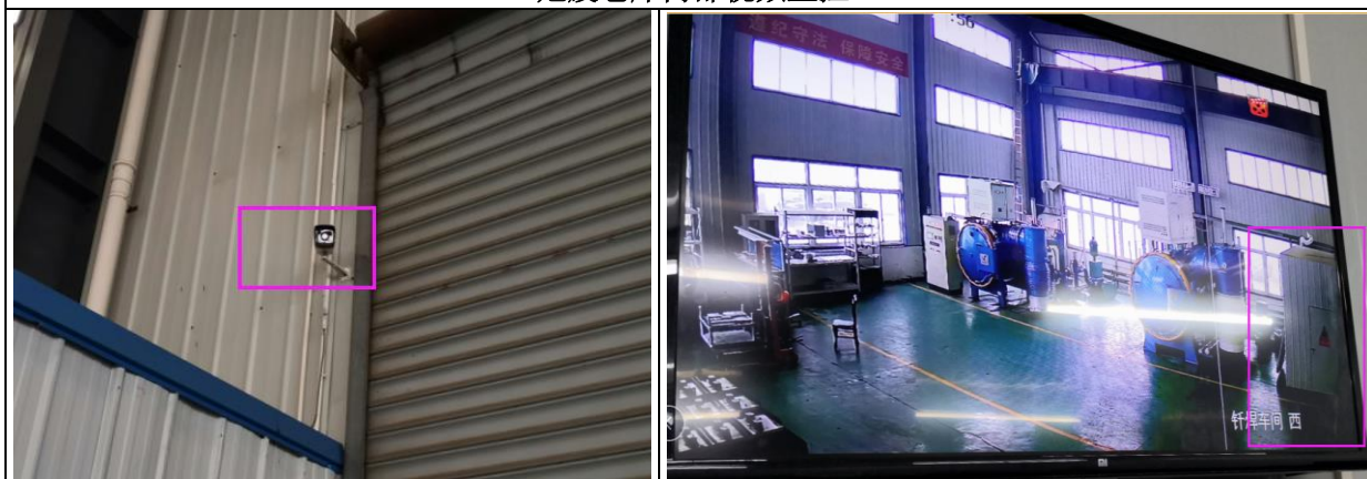
危废仓库外部视频监控
